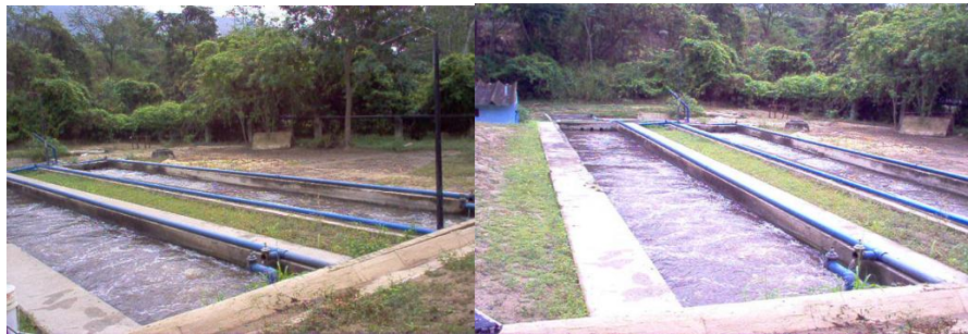
Figura 2 Planta de tratamiento de aguas residuales de uso doméstico, La Entrada. Municipio Naguanagua. Estado Carabobo.
