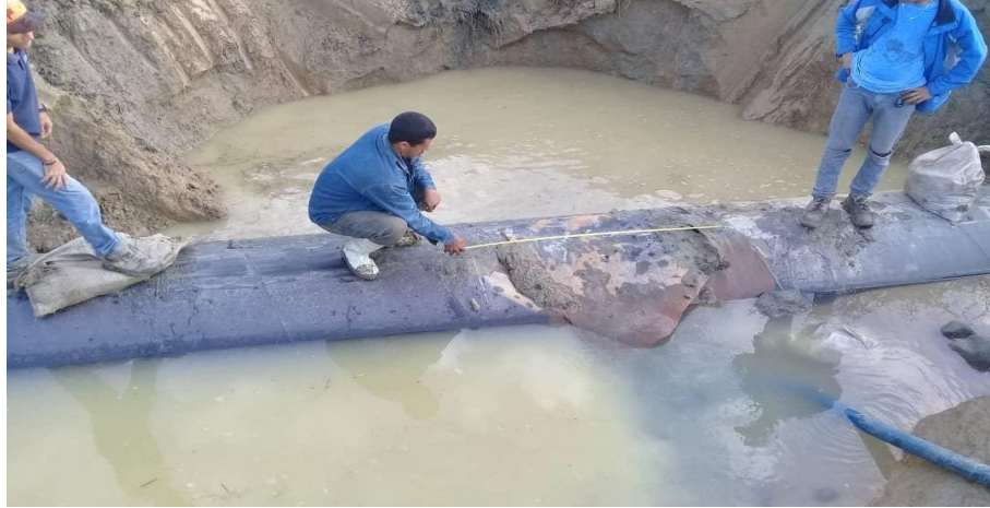
Figura 1. Redes de agua potable y sistema de cloacas de Hidrocentro cumplieron su vida útil
