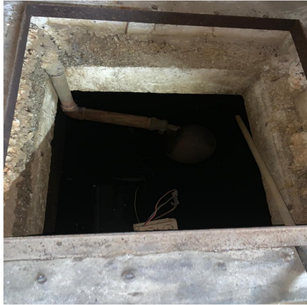
Figura 15. Tanque de almacenamiento Resd. Río Apure
