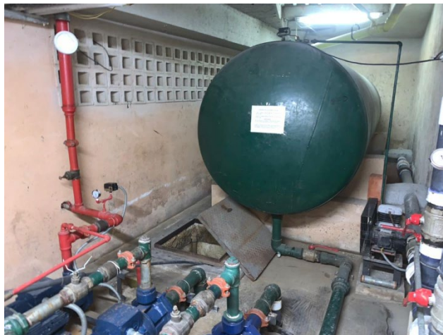
Figura 16. Condiciones actuales del cuarto de bombas
