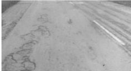
Figura 14. Desintegraciones por Peladuras
