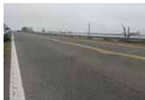
Figura 3. Falla por hundimiento
