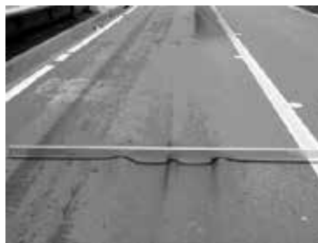
Figura 2. Falla por Ahuellamiento
