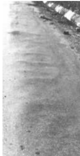
Figura 4. Falla por Corrugación
