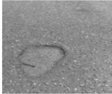
Figura 16. Desintegraciones por Baches
