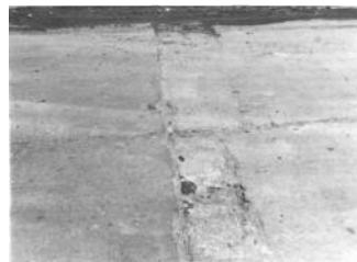
Figura 36. Falla por mal funcionamiento de juntas.
