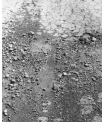
Figura 20. Desintegraciones por exudación Agua/Bombeo.
