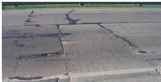
Figura 9. Fisura en Bloque
