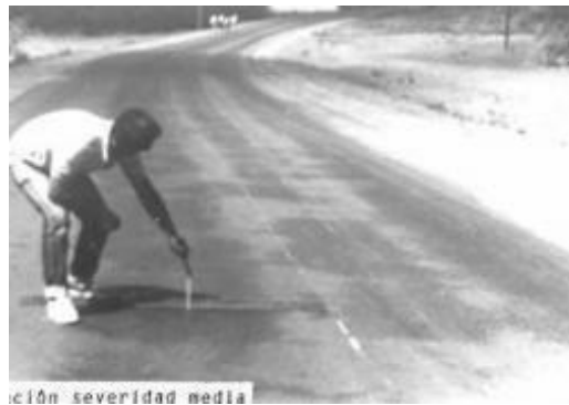
Figura 19. Desintegraciones por exudación de asfalto.
