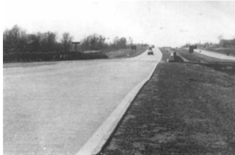
Figura 32. Falla por Hundimiento de pavimento rígido.
