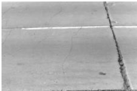
Figura 27. Fisura transversal de pavimento rígido.
