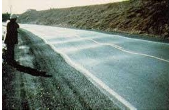
Figura 6. Falla por Hinchamiento.
