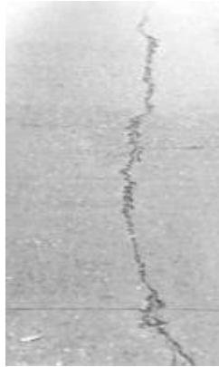
Figura 26. Fisura Longitudinal pavimento rígido.
