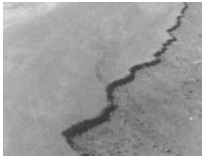
Figura 17. Desintegraciones por Rotura de Bordes.
