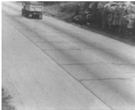
Figura 11. Falla Flexión de Juntas.
