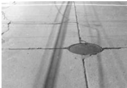
Figura 29. Fisura errática o inducida.
