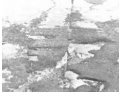
Figura 30. Rotura por Bombeo.
