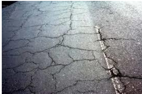
Figura 10. Falla piel de cocodrilo
