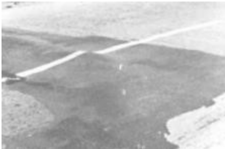
Figura 33. Falla por levantamiento.
