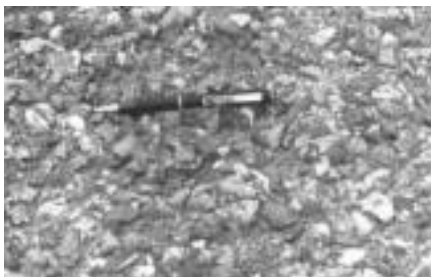
Figura 13. Desintegraciones por Desprendimiento
