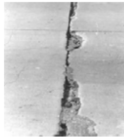
Figura 35. Falla por desportillamiento.
