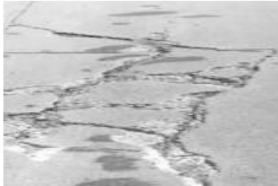
Figura 28. Rotura o bache de pavimento rígido
