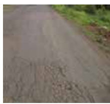
Foto 28 / PROG 28+700 GRIETA PIEL DE COCODRILO
