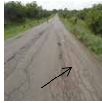
Foto 32 / PROG. 29+800 GRIETA PIEL DE COCODRILO
