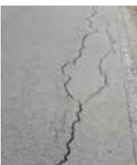
Foto 17/ PROG. 10+68 GRIETAS DE BORDE
