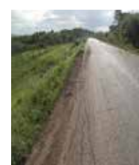
Foto 23/ PROG 25+ 370 GRIETA DE BORDE
