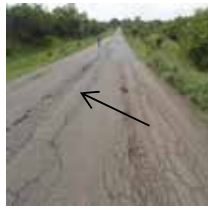
Foto 33 / PROG. 29+800 GRIETA PIEL DE COCODRILO
