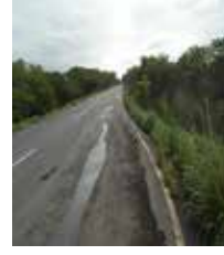
Foto 44 / PROG. 33+700 DEFORMACION POR EMPUJE
