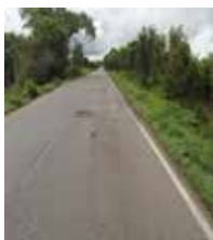
Foto 7 /PROG. 3+940 GRIETA PIEL DE COCODRILO
