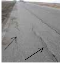
Foto 26/ PROG. 27+156 GRIETA DE BORDE
