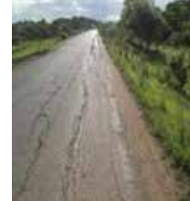
Foto 38 / PROG 31+280 GRIETAS LONGITUDINALES
