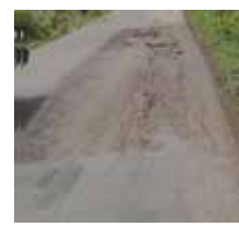
Foto 30 / PROG 29+260 GRIETA PIEL DE COCODRILO
