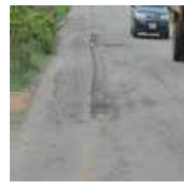
Foto 29 / PROG 28+980 DISGREGACIÓN Y DESINTEGRACION
