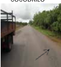
Foto12/ PROG 6+510 GRIETA PIEL DE
