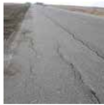
Foto 27 /PROG. 27+ 160 GRIETA LONGITUDINAL
