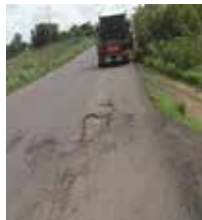
Foto 36 /PROG. 30+200 DISGREGACION Y DESINTEGRACIÓN
