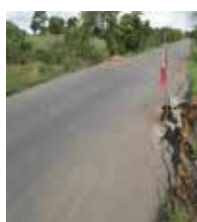
Foto 6 /PROG. 3+488 FALLA DE BORDE
