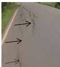
Foto 41 / PROG 32+700 GRIETA DE BORDE
