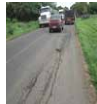
Foto 34 / PROG 30+085 GRIETA PIEL DE COCODRILO
