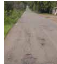
Foto 8 /PROG. 4+790 GRIETA PIEL DE
