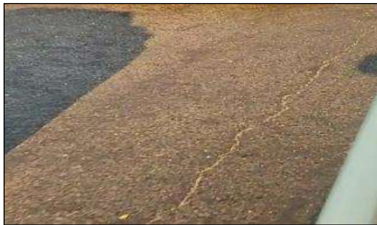
Figura 93. Fisura longitudinal en la calle Páez
