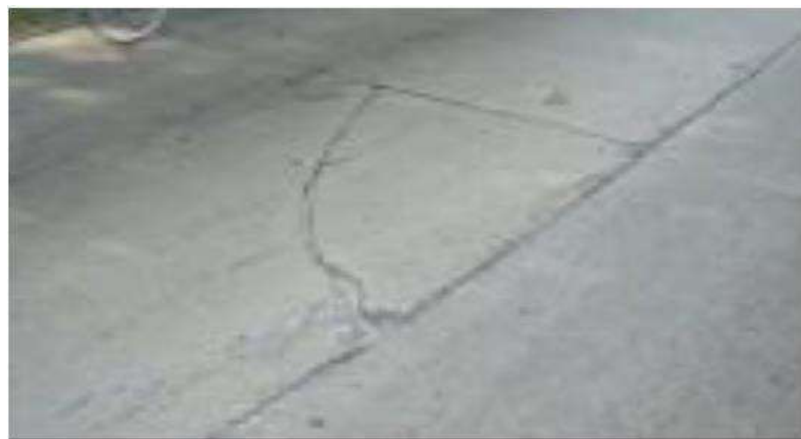
Figura 14. Grietas de esquina en el Pavimento Rígido
