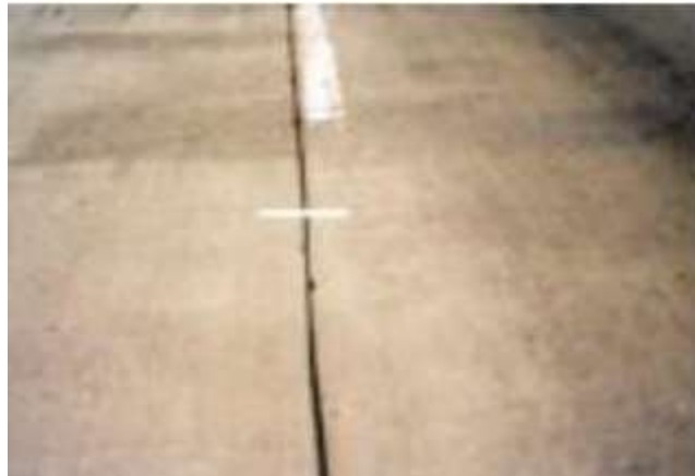
Figura 13. Separación Longitudinal de la junta en el Pavimento Rígido
