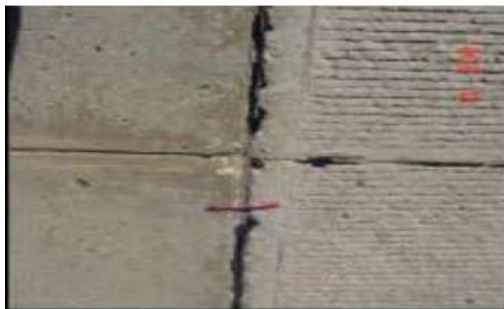
Figura 11. Deficiencias del Sellado en el Pavimento Rígido
