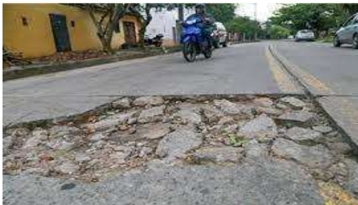
Figura 19. Baches en el pavimento rígido
