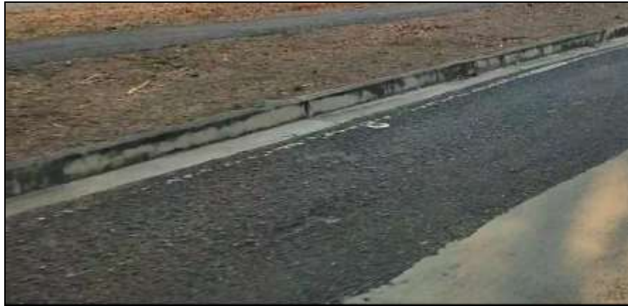
Figura 91. Pérdida del agregado en la calle Páez
