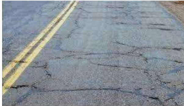
Figura 8. Fisura del pavimento flexible
