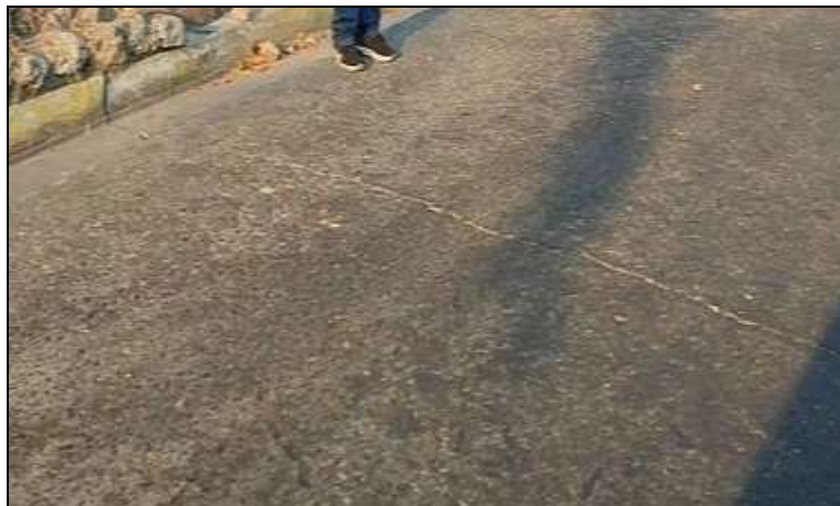
Figura 94. Fisura transversal en la calle Páez
