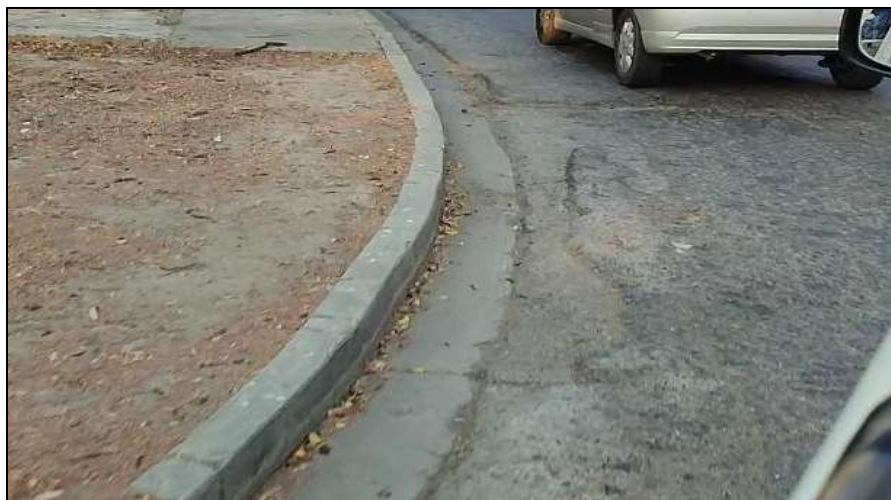
Figura 92. Desintegración por rotura de borde en la calle principal de Montserino
