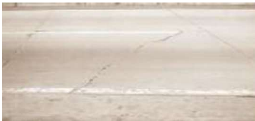
Figura 16. Grietas Transversales en el pavimento rígido
