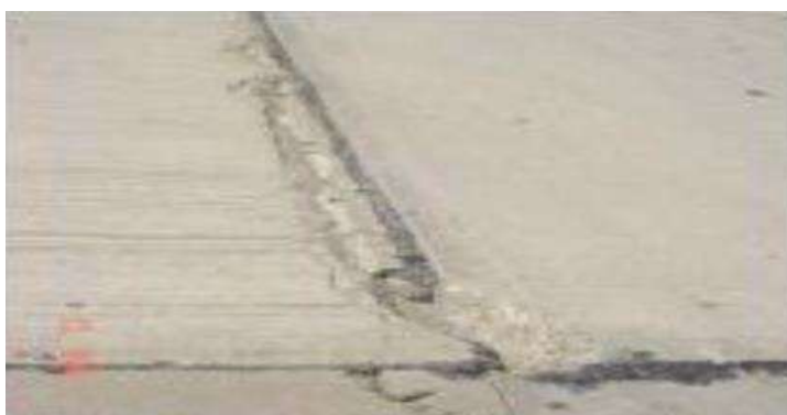
Figura 12. Juntas Saltadas en el Pavimento Rígido
