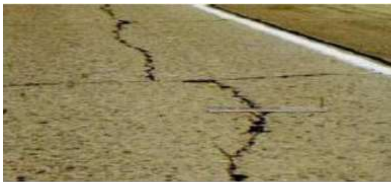
Figura 15. Grietas Longitudinales en el pavimento rígido
