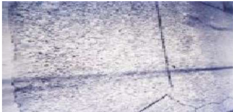
Figura 17. Fisuramiento por retracción en el pavimento rígido
