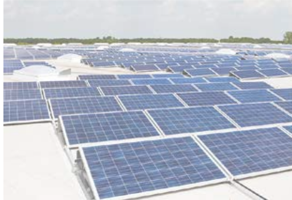
Figura 75: Cubierta de paneles solares. (2015)
