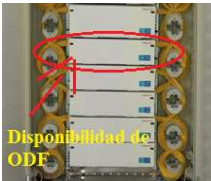
Figura 24: Vista del ODF tipo cajón marca OPTICO, ubicado en el Piso 1/ Fila B/Rack 02.
