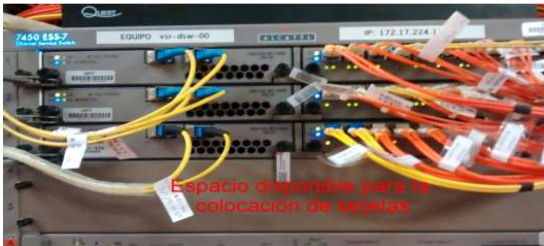
Figura 39: Vista del Switch marca 7450 EES-7 Alcatel, ubicado en el Piso 2/ Fila A/Rack 02
