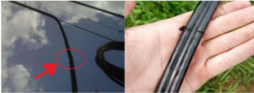
Figura 4: Evidencia de cable FO cortado por el vandalismo Fuente: CANTV 2022
