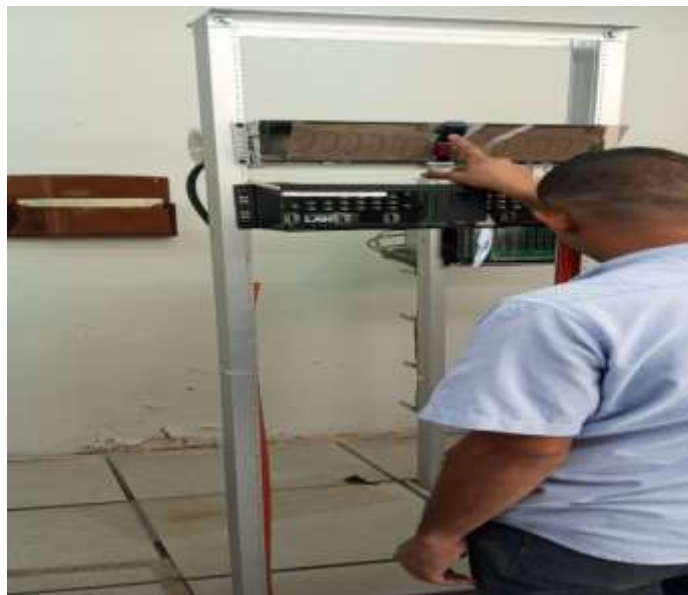
Figura 36: Vista del ODF tipo bandeja marca Tayco, ubicado en el Piso 2/ Fila B/Rack 03.
