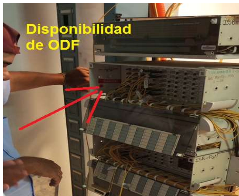
Figura 20: Vista del ODF tipo cajón marca OPTICO, ubicado en el Piso PB/ Fila D/Rack 02. Fuente: Obed Torrealba 2022.
