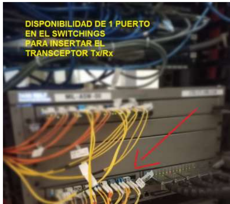
Figura 19: Vista del Switch marca 7450 EES-12 Alcatel, ubicado en el Piso PB/ Fila A/Rack 02 Fuente: Obed Torrealba 2022.
