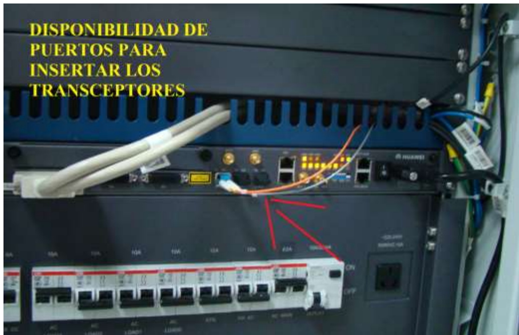
Figura 27: Vista del rack y Switch, marca DWDM Huawei, ubicado en el Piso PB/ Fila A/Rack 03.
