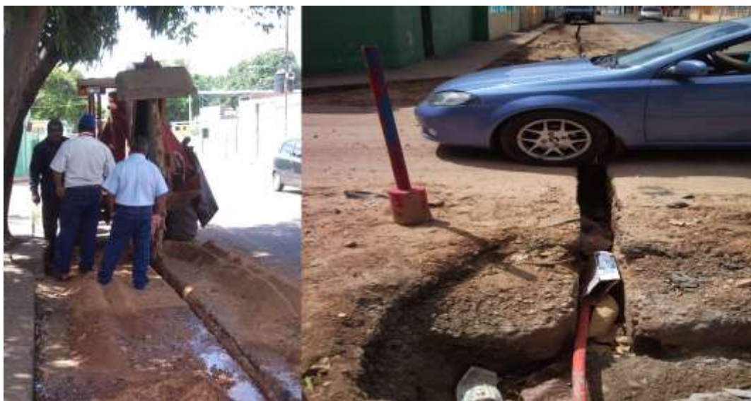
Figura 5: Evidencia de cable FO cortado por falta de señalización Fuente: CANTV 2021
