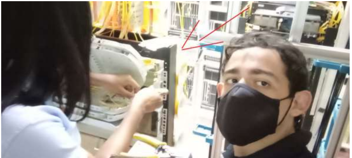
Figura 32: Vista del ODF tipo bandeja marca Tayco, ubicado en el Piso PB/ Fila C/Rack 03.
