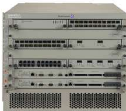
Figura 10: Switch Service Ethernet Modelo 7450 ESS-7, Marca Alcatel.
