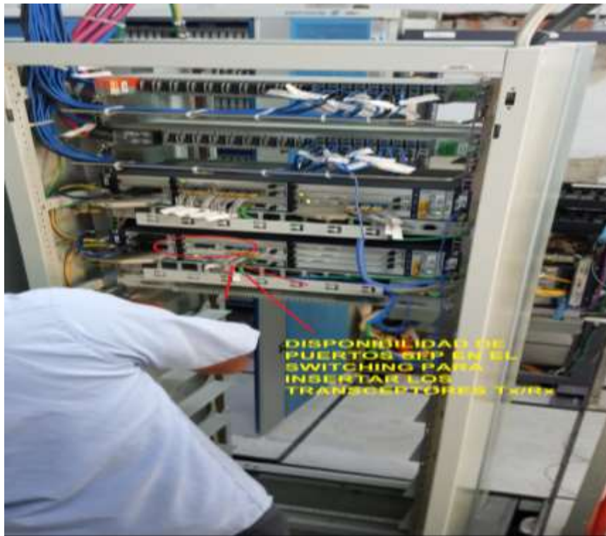
Figura 35: Vista del Switch marca DWDM Huawei, ubicado en el Piso 2/ Fila A/Rack 02.
