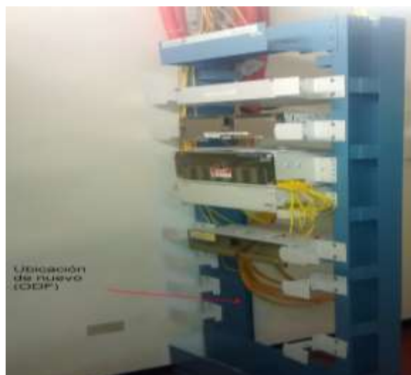
Figura 40: Vista del Rack del ODF tipo bandeja, ubicado en el Piso 2/ Fila C/Rack 02.
