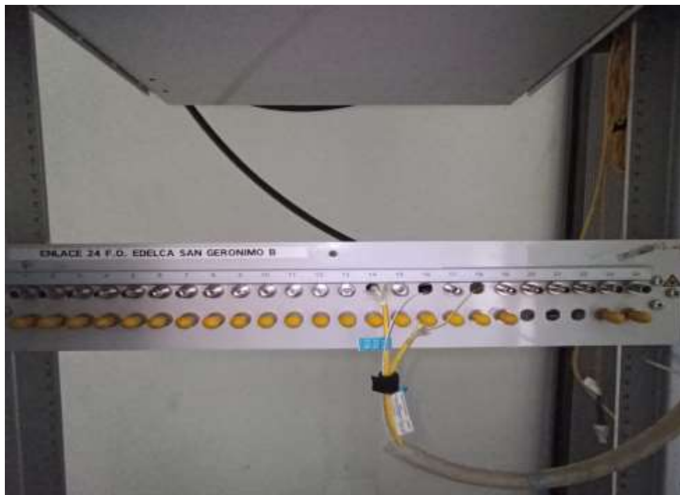
Figura 28: Vista del ODF, ubicado en el Piso PB/ Fila B/Rack 02.
