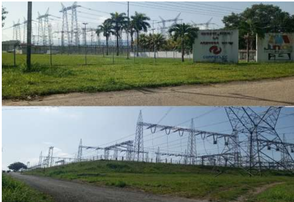
Figura 26: Vista del frente de la Subestación “La Arenosa”.
