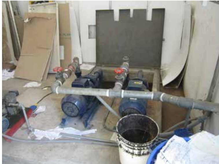
Figura 32. Sistema de bombeo. Fuente: Carly Dávila, Alexandra Rosero 2018.
