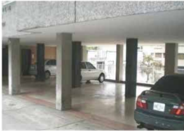
Figura 17. Ausencia de vigas altas en las dos direcciones. Fuente: Informe técnico FUNVISIS 2014.
