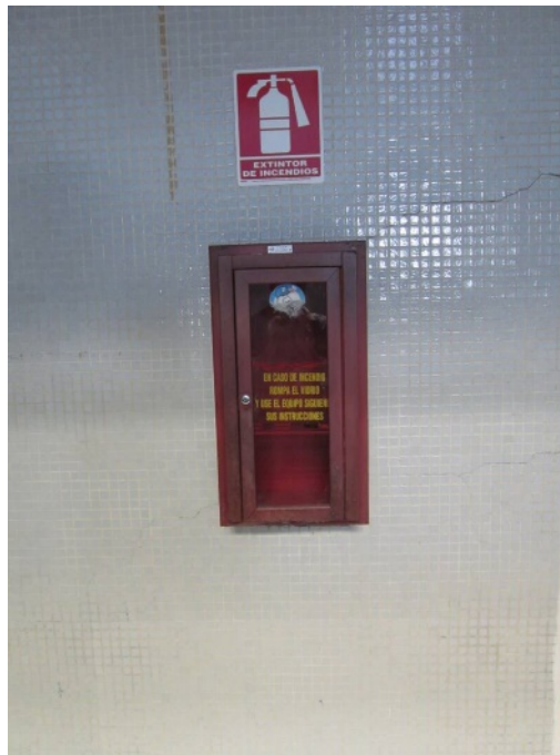
Figura 28. Casilla de extintores. Fuente: Carly Dávila, Alexandra Rosero 2018.
