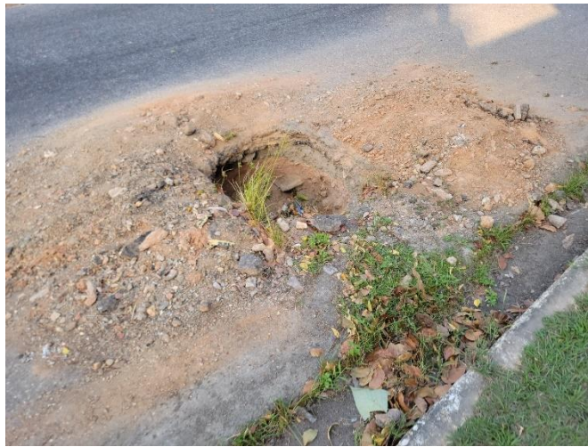
Figura 18: Deterioro en la vía.
