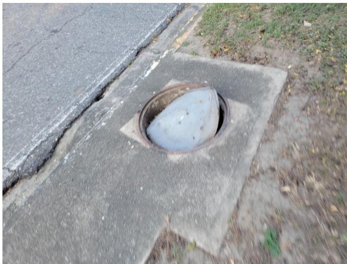
Figura 19: Boca de visita en mal estado.
