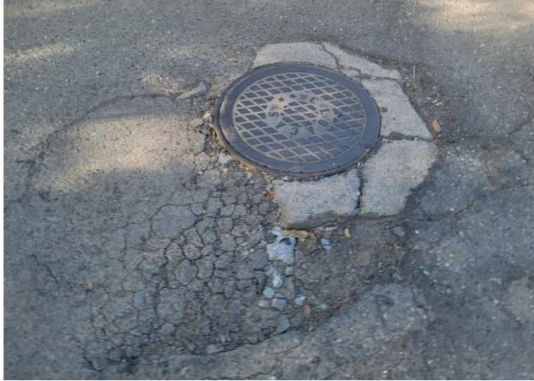
Figura 17: Falla de Hueco.
