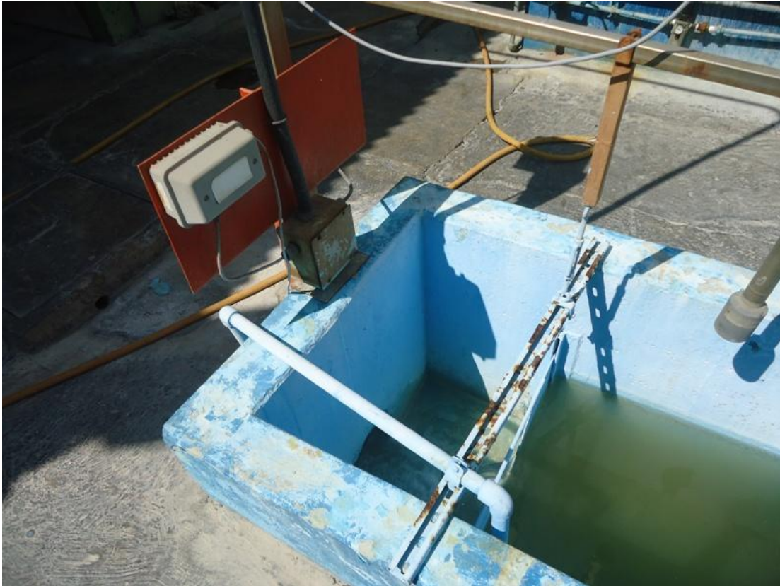
Figura 19: Canalizador Final en PTAR. Imagen tomada por el autor. (2019).
