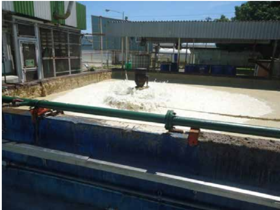
Figura 12: Tanque de igualación de PTAR. Imagen tomada por el autor. (2019).
