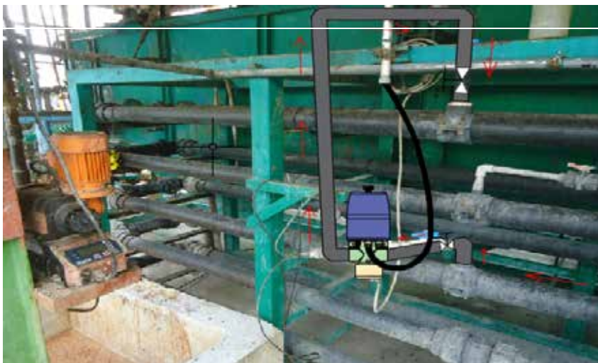
Figura 30: Propuesta ilustrada de la instalación con Bypass en la entrada del serpentín del DAF TK-10002. Fuente: Realizado por el autor(2019).
