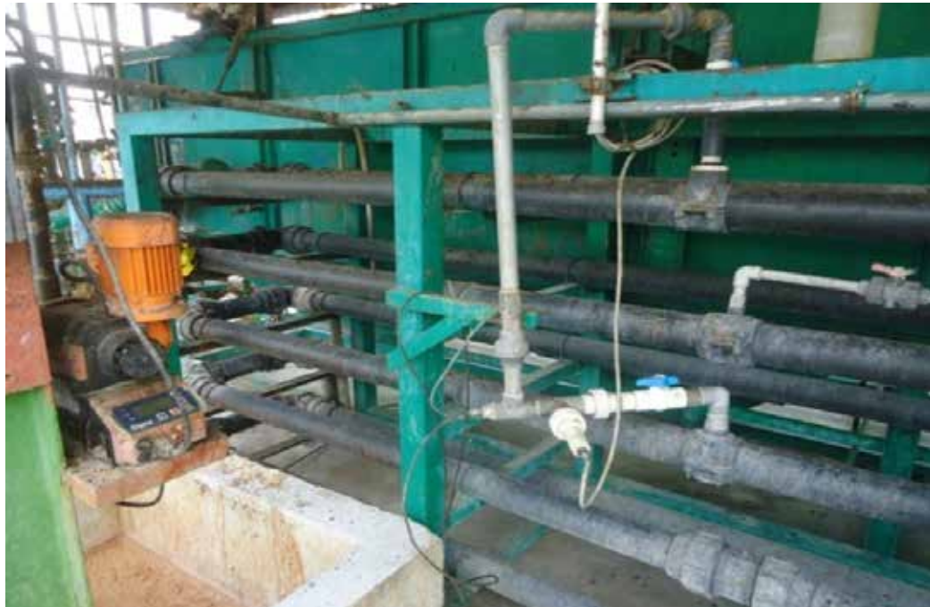
Figura 13: Serpentín del DAFTK-10002(Flotación por aire disuelto).
