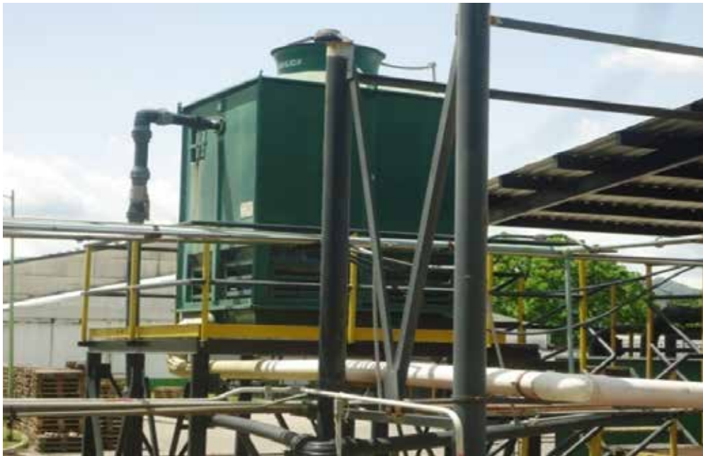
Figura 16: Torre de enfriamiento en PTAR. Imagen tomada por el autor. (2019).
