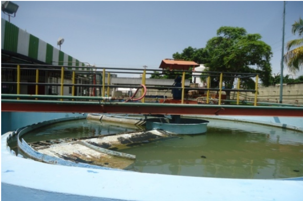
Figura 18: Tanque clarificador en PTAR. Imagen tomada por el autor. (2019).
