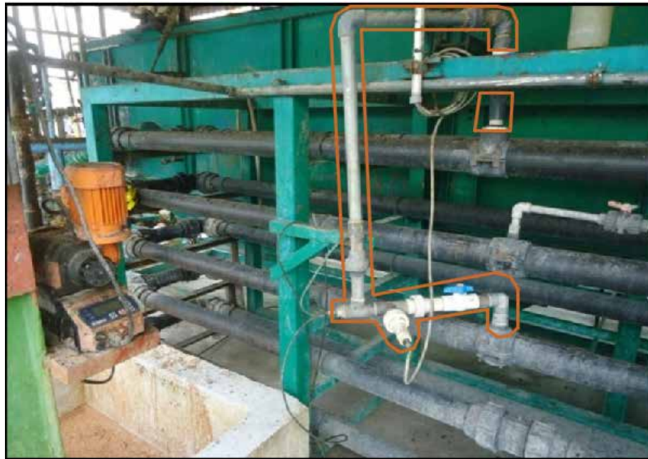
Figura 29: Propuesta de dismantelamiento de tuberías y válvulas, instalados en el serpentín. Fuente: Realizado por el autor(2019)
