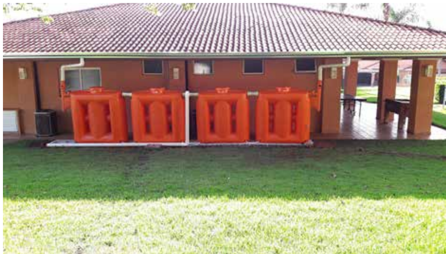
Figura N°32: Tanques exteriores modulares.
