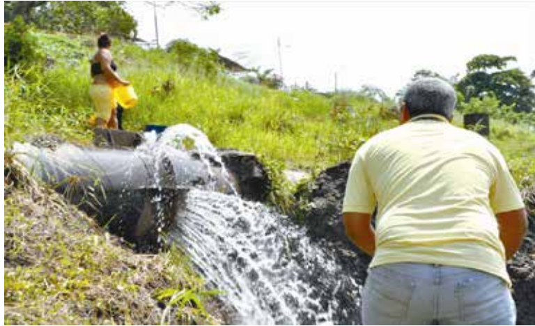
Figura N°11: Acueducto sector Los Naranjos
