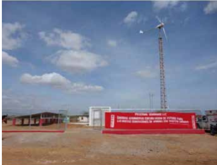
Figura 7 - Sistema híbrido instalado en la comunidad Los Arroyos, Estado Falcón
