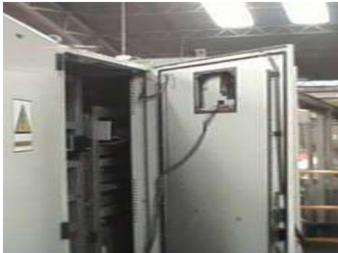
Figura 15. Tableros abiertos cerca de la termoencogible.
