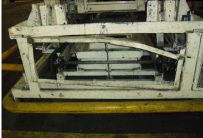
Figura 9. Defensas en mal estado en la paletizadora.
