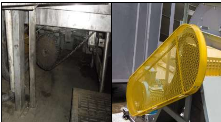
Figura 30. Antes y Después de una instalación de Guarda de Maquina para Piezas Giratorias.
