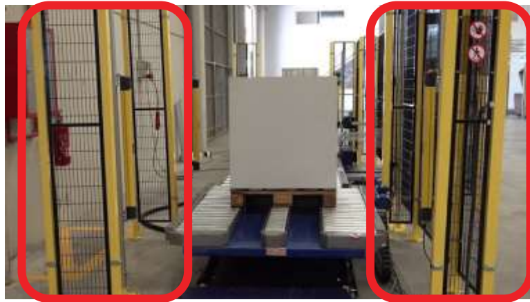
Figura 29. Propuesta de Instalación de Guarda de Maquina. Fuente: Rivera, R (2024)
