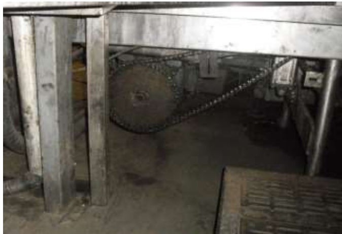
Figura 10. Cadenas sin protección de atrapamiento y sin señalización
