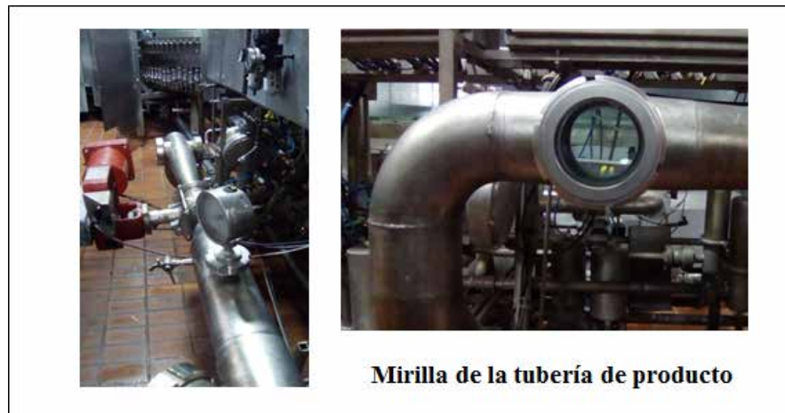
Figura 17. Tubería de producto a la entrada de la llenadora T11. Fuente: Barrios, F (2018)
