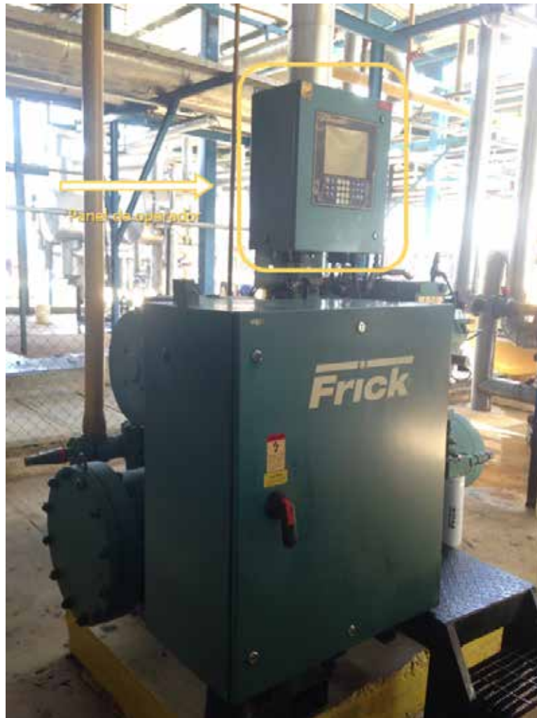
Figura 15. Compresor para el área de agua fría conjunto con su panel de operador
