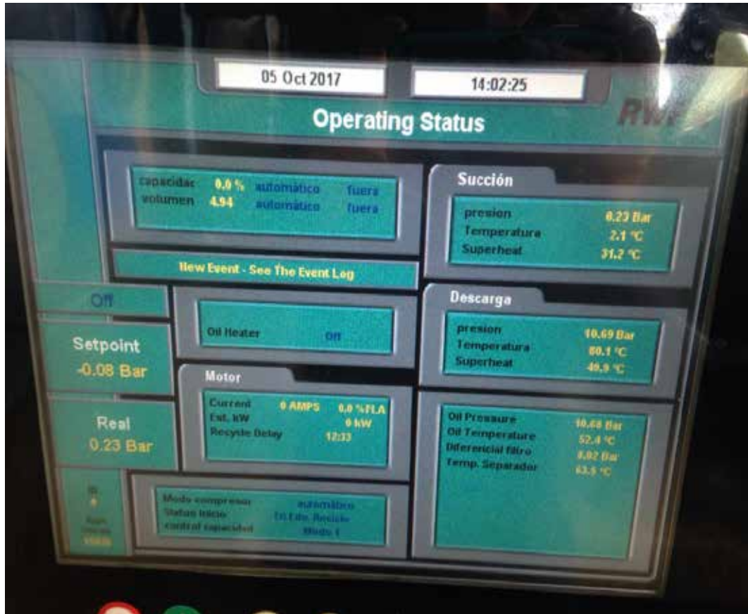
Figura 16. Panel de operador de los compresores Fricks
