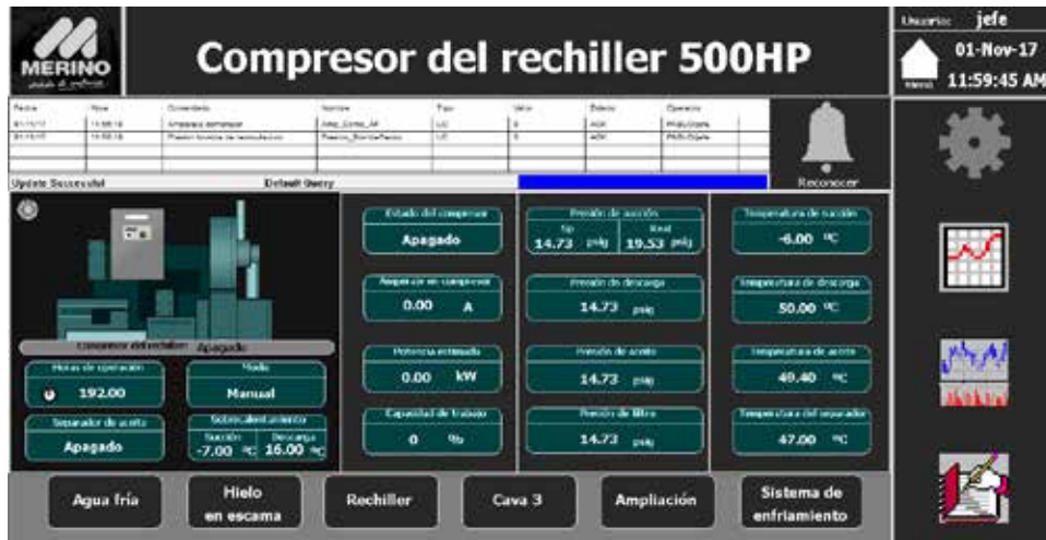
Figura 42. Pantalla del compresor para el sistema del rechiller
