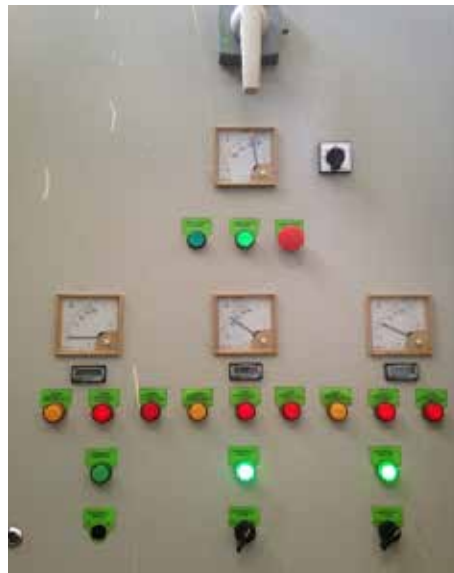
Figura 31. Tablero de control para compresores de alta y baja presión
