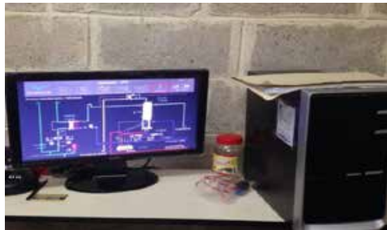
Figura 23. Sistema de supervisión actual de la cava 3 y despresado
