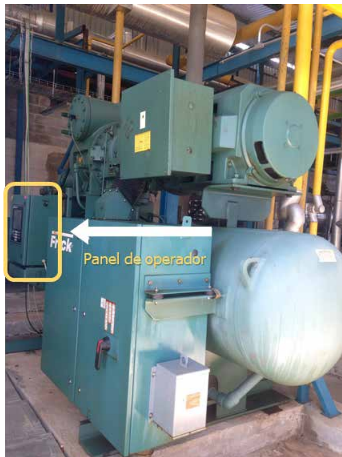
Figura 13. Compresor para el sistema de reenfriamiento de agua conjunto con su panel de operador
