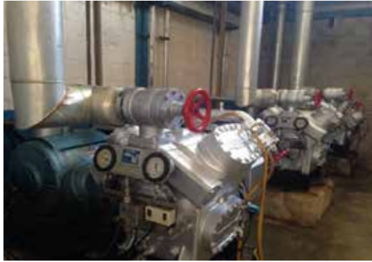
Figura 30. Compresores Sabroe de alta y baja presión para los túneles 1 y 2
