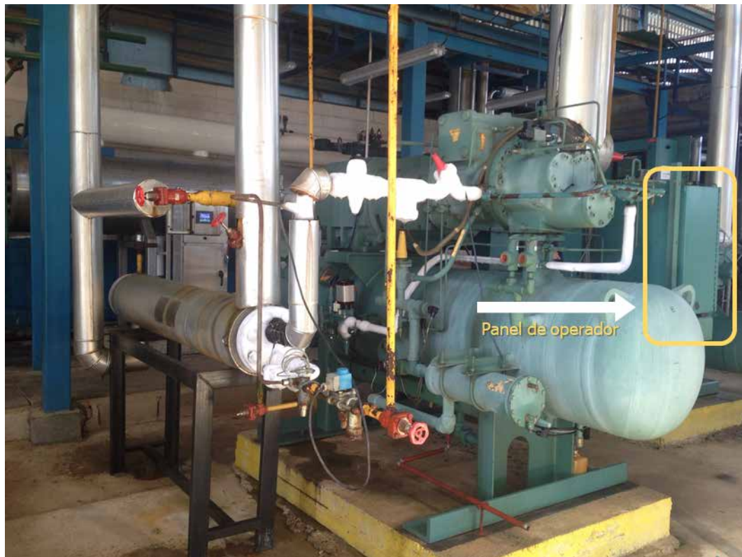
Figura 14. Compresor para la planta de hielo en escama conjunto con su panel de operador
