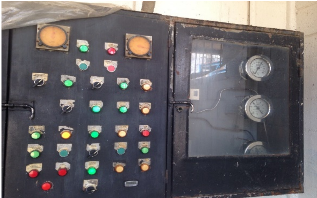
Figura 33. Tablero de control, para el compresor Mycom de planta de hielo
