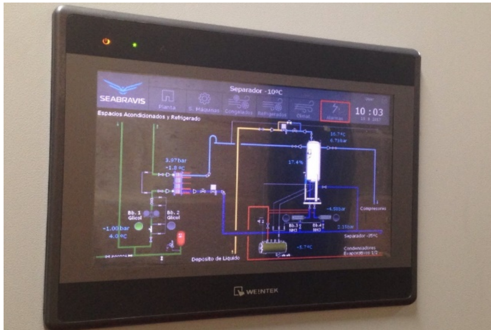
Figura 24. Panel de visualización ubicado en sala de máquinas
