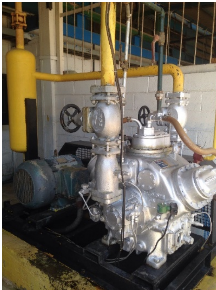
Figura 32. Compresor Mycom para la planta de hielo
