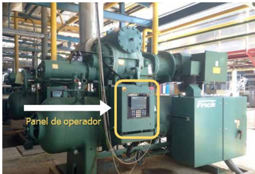
Figura 12. Compresor para el sistema de cavas de congelación conjunto con su panel de operador
