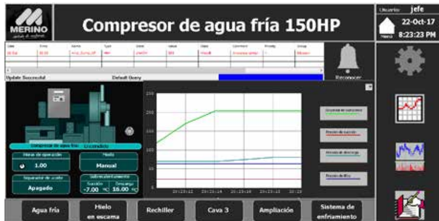
Figura 46. Pantalla de tendencia real para el compresor de agua fría
