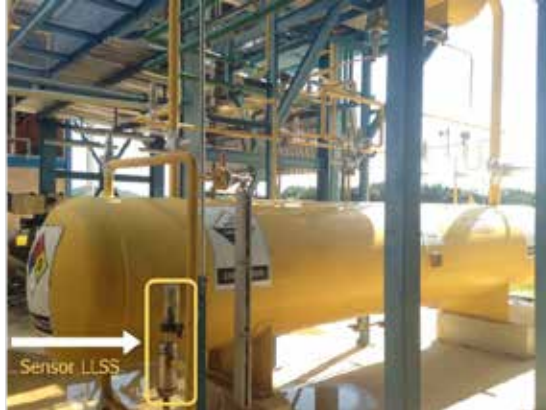
Figura 22. Sensor LLSS para el tanque receptor
