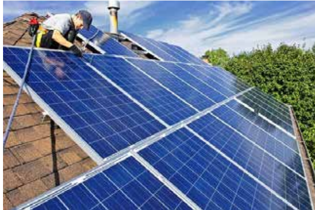
Figura 69. Paneles Solares. Fuente: https://erenovable.com/wp-content/uploads/2015/03/ventajas-panel-solar-600x400 (2015)
