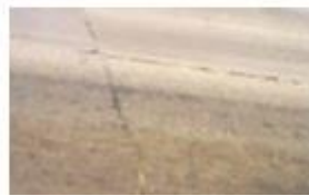
Figura 11. Juntas saltadas en pavimento rígido Fuente: (mantenimientocarreterasvias, 2020)
