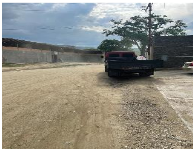
Figura 34. Deterioro de la vía
