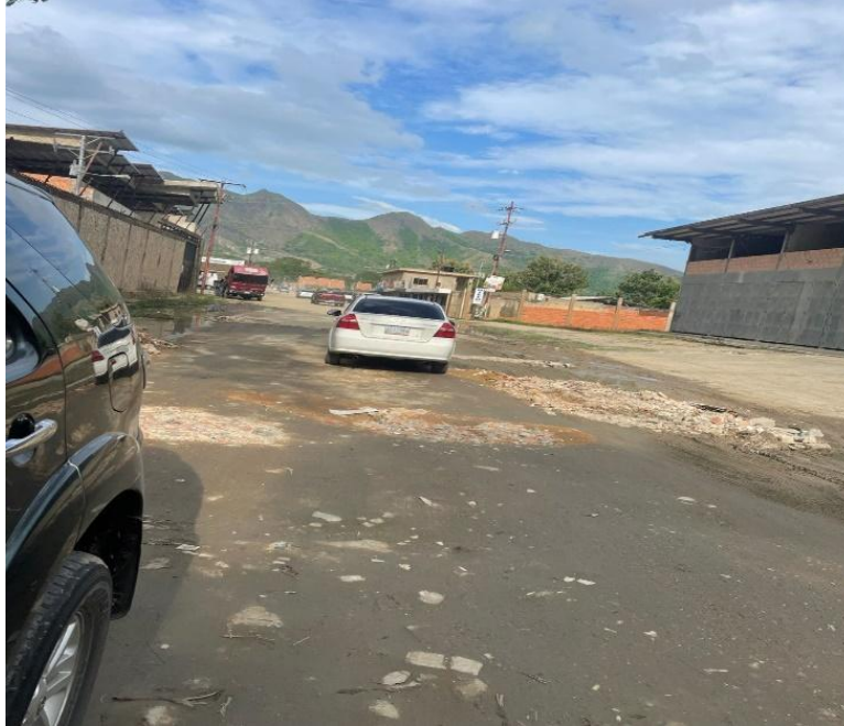
Figura 35. Mal estado de la vía Fuente: Blanco y Sosa (2022)
