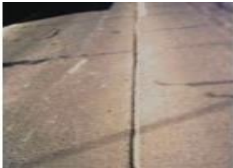
Figura 12. Separación de juntas longitudinales Fuente: (mantenimientocarreterasvias, 2020)
