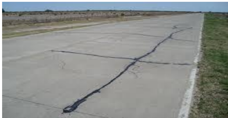
Figura 14. Grietas Longitudinales en pavimento rígido
