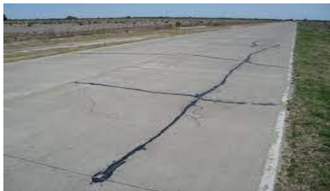
Figura 10. Deficiencias de sellado en pavimento rígido Fuente: (Calo, 2016)
