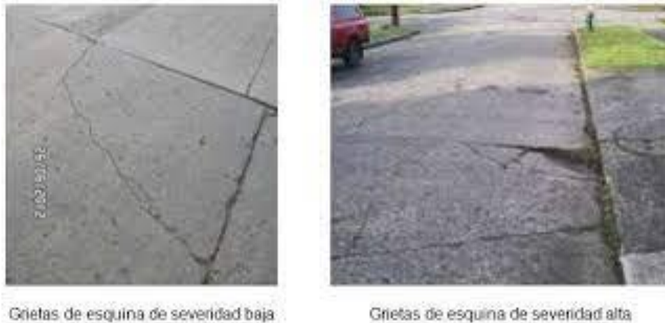
Figura 13. Grietas de esquina en pavimento rígido
