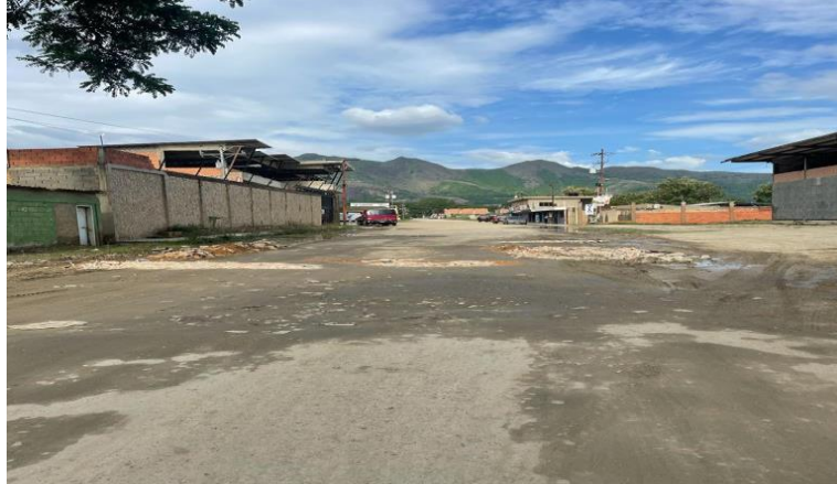
Figura 2. Estado actual de la vía Callejón Los Cocos Fuente: Blanco y Sosa (2022)
