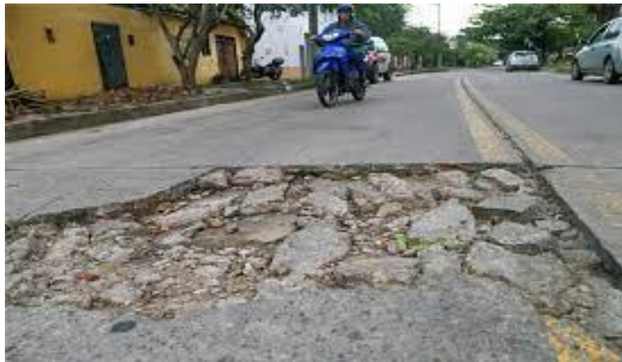
Figura 18. Baches en pavimento rígido Fuente: (redpat, 2022)
