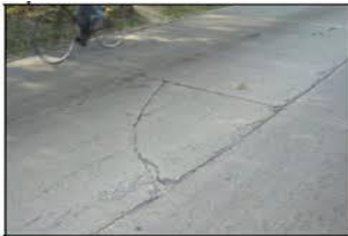
Figura 16. Fisuramiento por retracción en pavimento rígido
