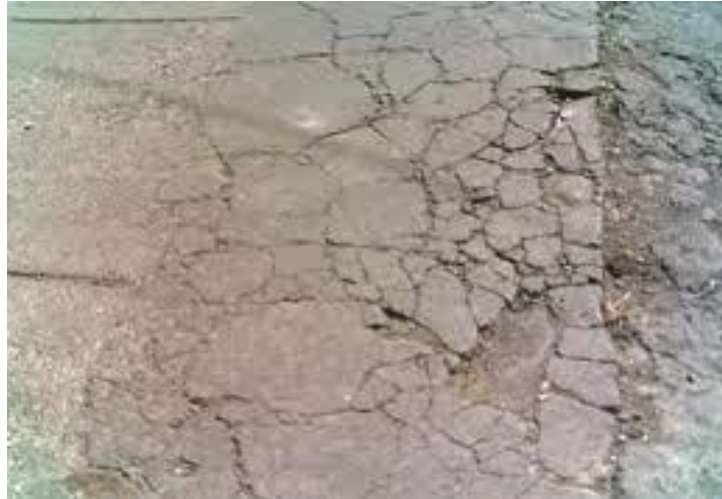
Figura 17. Desintegración en pavimento rígido Fuente: (Calo, 2016)
