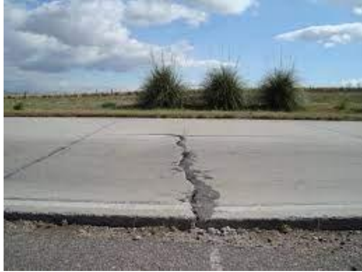
Figura 15. Grietas Transversales en pavimento rígido
