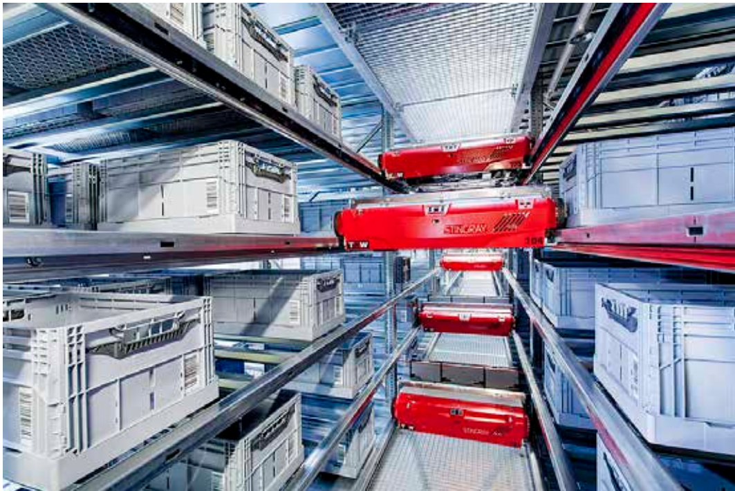
Figura 4. Sistema automatizado de almacenamiento y recuperación utilizando la tecnología Highly Dynamic TGW Stingray Shuttle .
