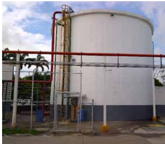
Figura 8. Vista del Tanque de Agua de Suministro de la empresa FCA Venezuela
