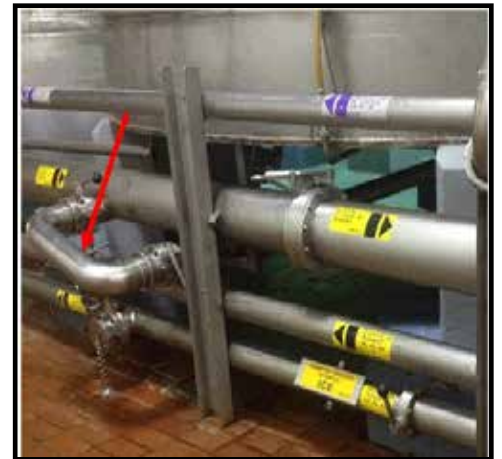
Imagen # 28. Codos y válvulas
