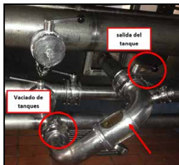
Imagen #2. Codo para el vaciado
