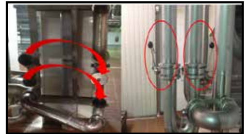
Imagen # 27. Codos y válvulas
