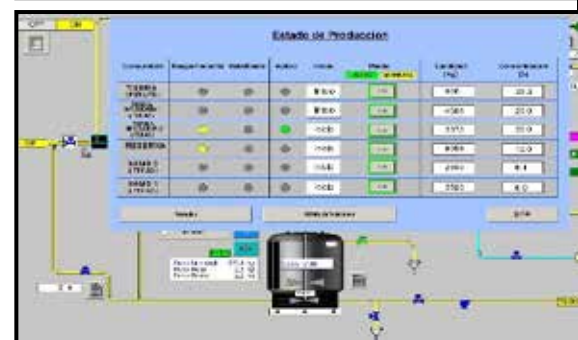
Imagen # 11. Activación de la tolva
