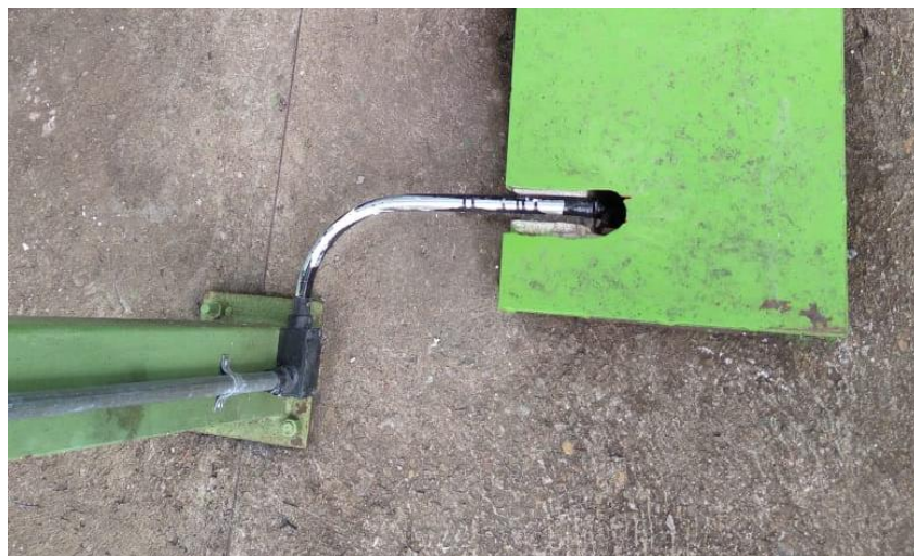
Figura 33. Tubería del cableado de los sensores
