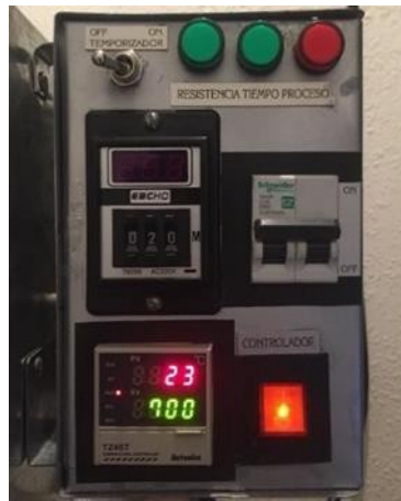
Figura 42. Encendido del controlador
