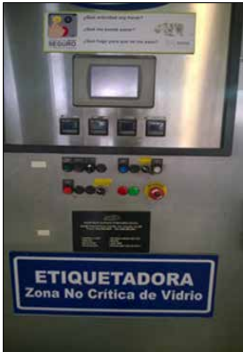
Figura 1: Tablero de control de etiquetadora Hot gluelabeler 960 PCD. Fuente: Nestlé Venezuela SA (2018).
