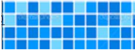
Figura 70. Textura de piso de paredes internas de las Piscinas. (2019).
