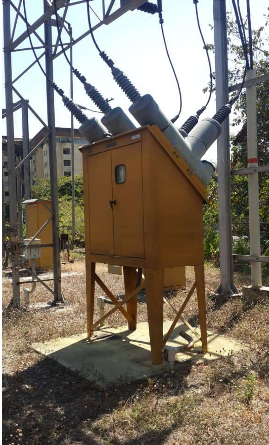
Anexo A4. Interruptor de potencia
