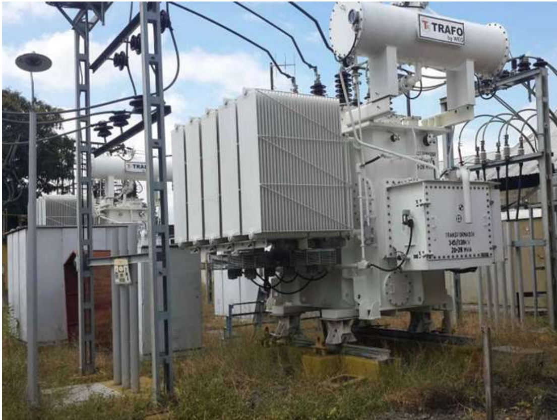
Figura 4. Transformador TRAF0 de 34.5/13.8kV
