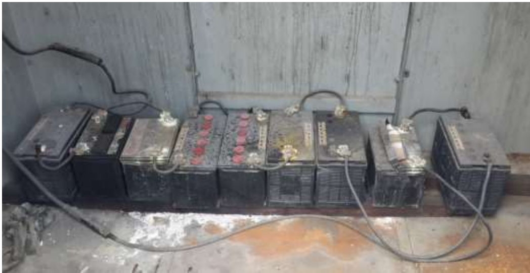
Figura 12. Baterías de respaldo
