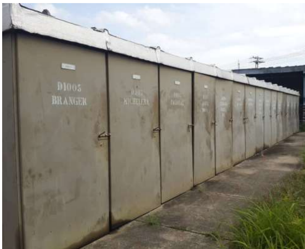
Figura 7. Celda de interruptores
