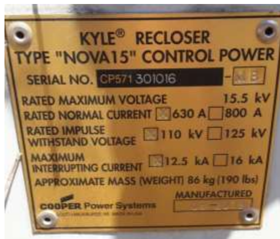
Figura 17. Placa de especificaciones técnicas
