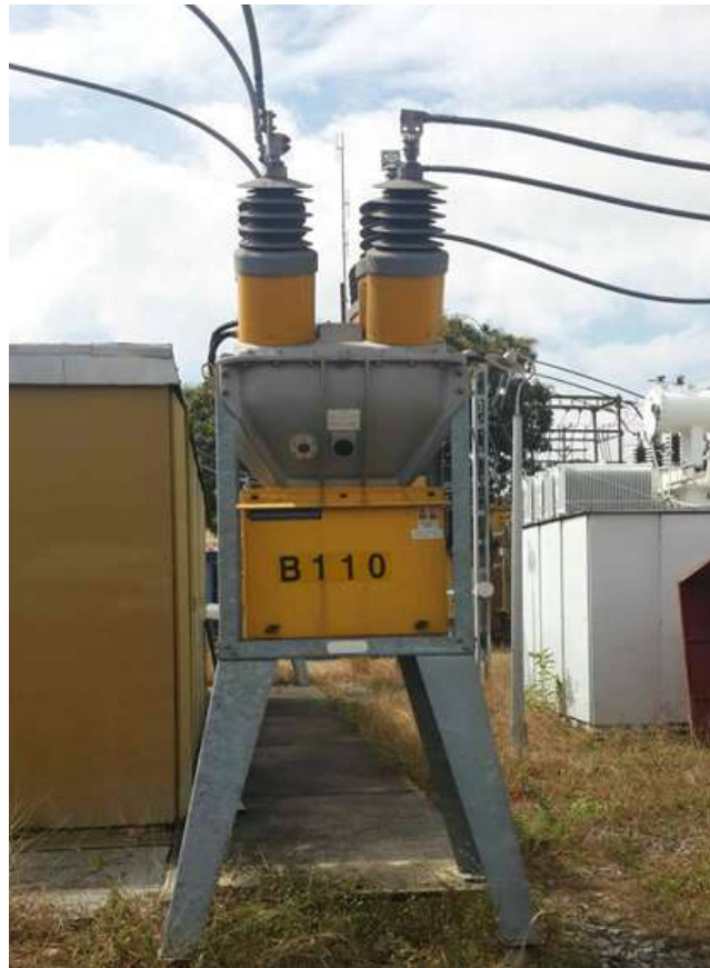
Figura 3. Interruptor de potencia encargado de proteger al transformador
