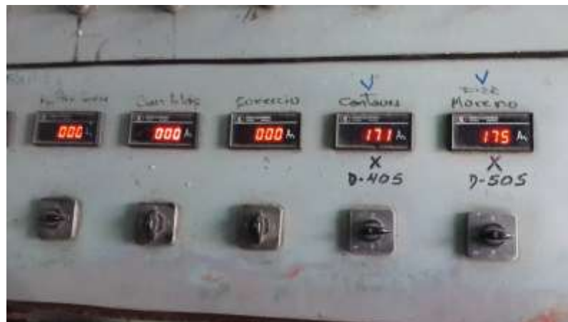
Figura 10. Tablero de medición y control
