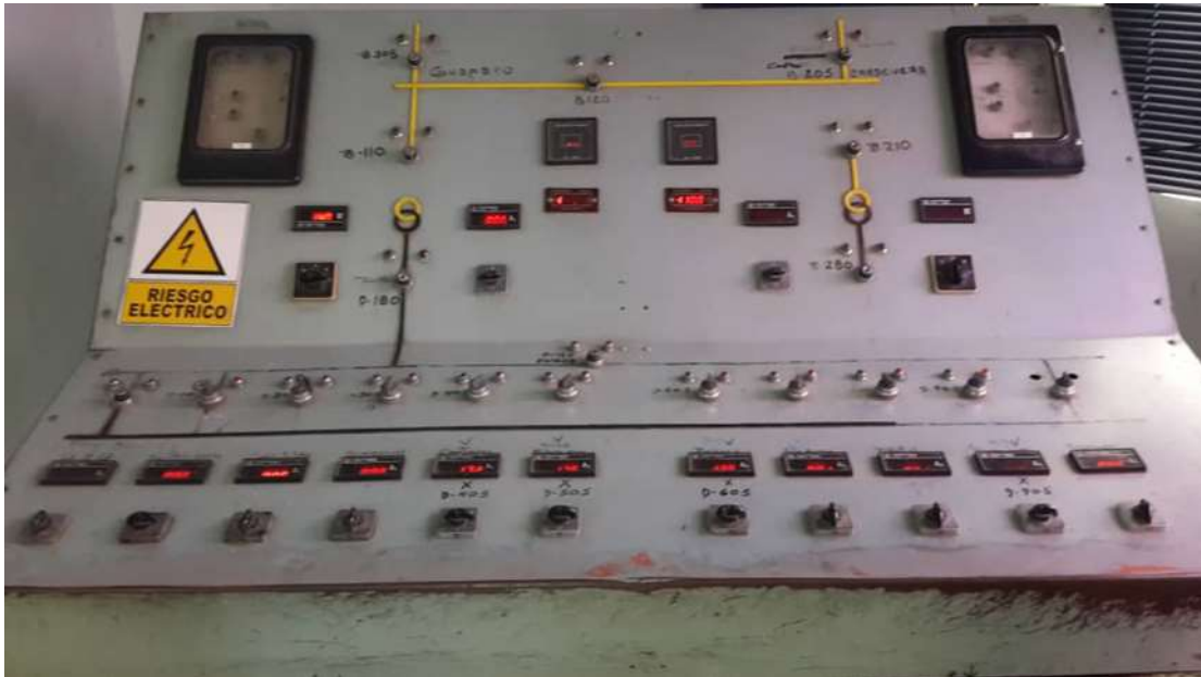
Figura 8. Tablero de medición y control
