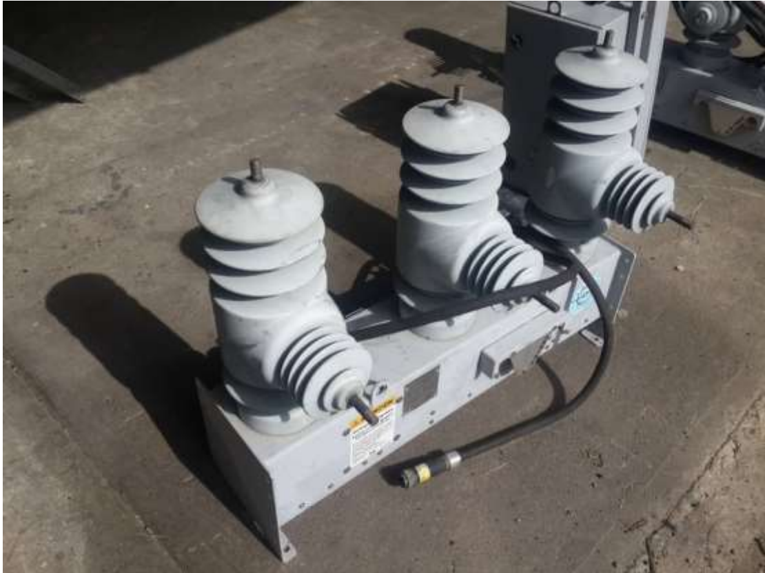
Anexo A1. Reconectador Cooper Nova Tipo 15
