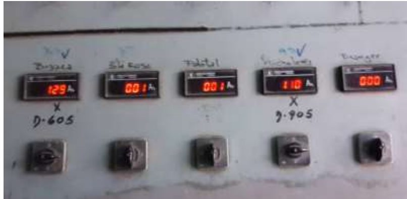
Figura 9. Tablero de medición y control
