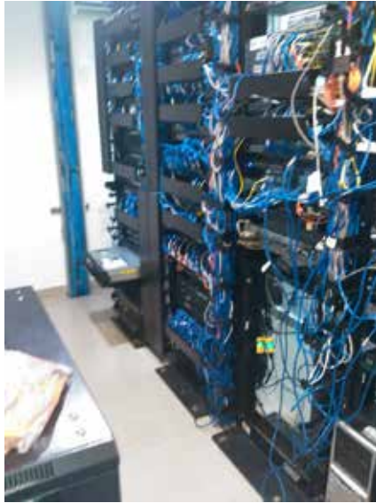
Figura 3. Cuarto de Servidores Fuente: Caro, Muñoz (2020)
