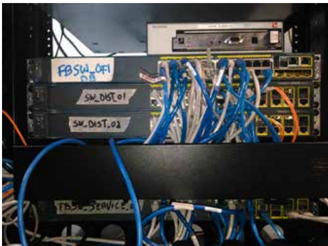
Figura 5. Switch de Distribución Fuente: Caro, Muñoz (2020)
