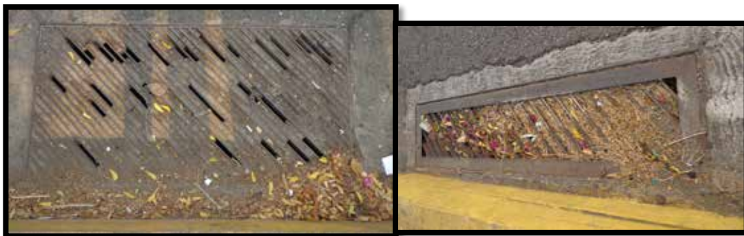
Figura 13. Sumidero de Rejilla Av. Don Julio Centeno
