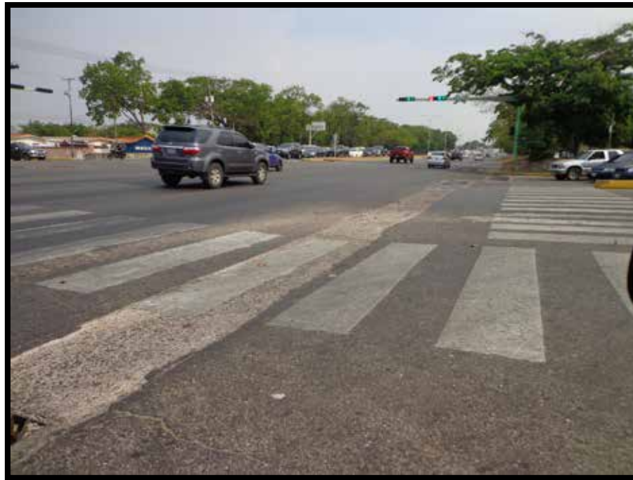
Figura 11. Daños Superficiales Av. Don Julio Centeno
