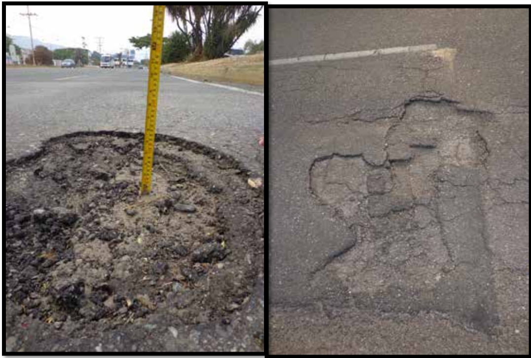
Figura 14. Daños Capa Estructural Av. Don Julio Centeno
