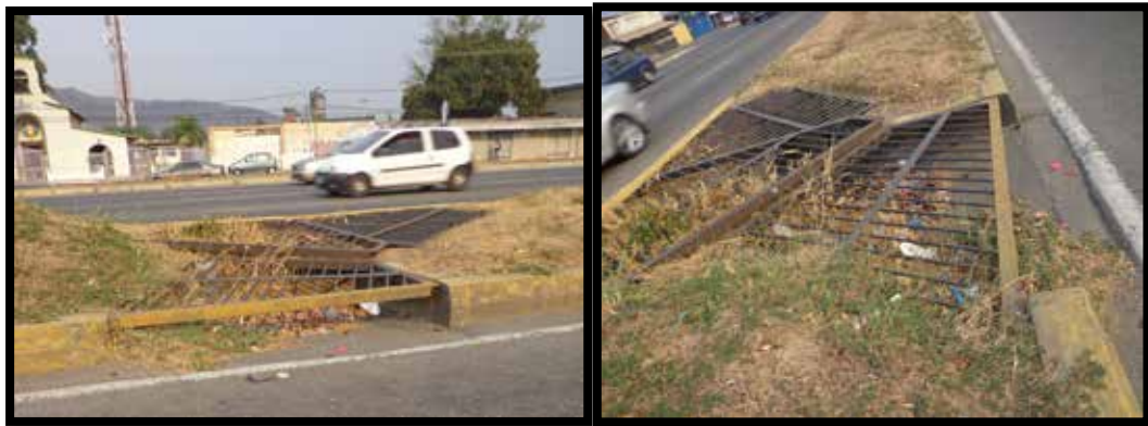
Figura 12. Sumidero de Ventana Av. Don Julio Centeno
