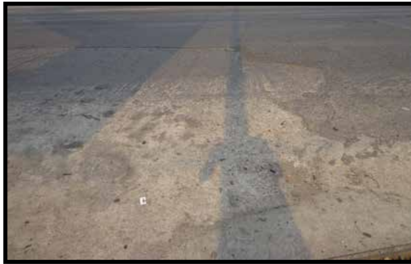
Figura 10. Deformaciones Av. Don Julio Centeno
