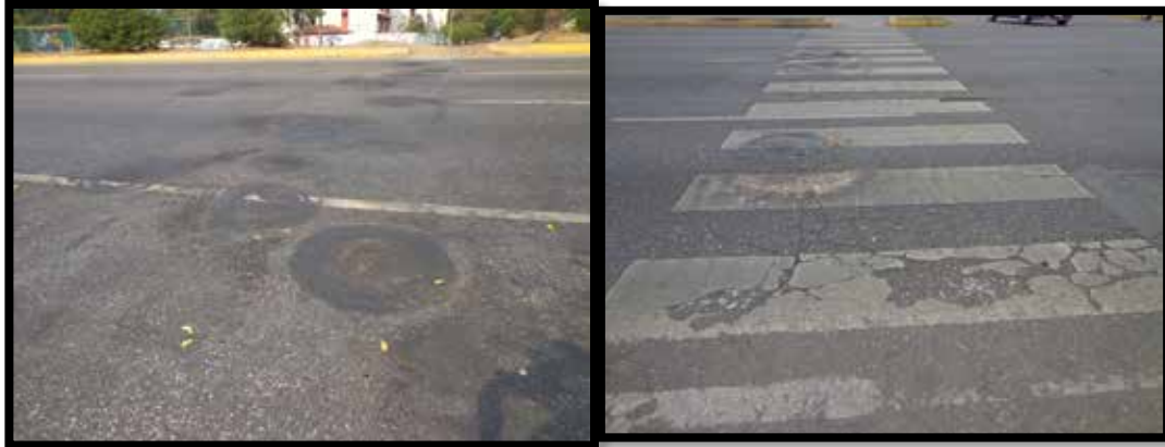
Figura 15. Daños causados por la mala acción del hombre
