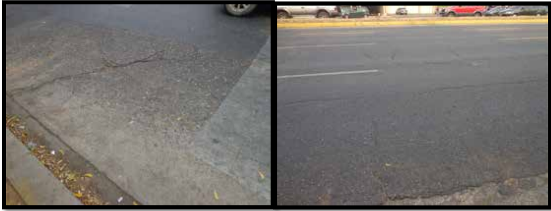
Figura 9. Fisuras Av. Don Julio Centeno
