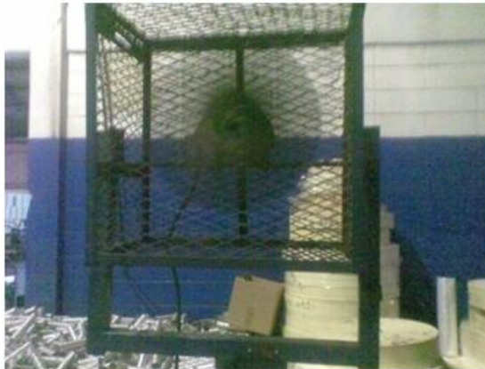
Figura 16. Ventilador del área.
