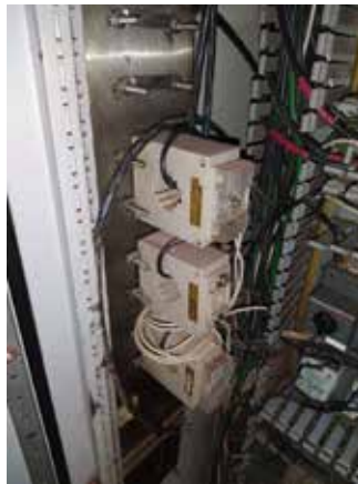
Figura 28: Transformador de corriente del motor del enrollador
