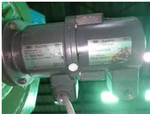
Figura 27: Tacómetro dinamoétrico del motor del enrollador
