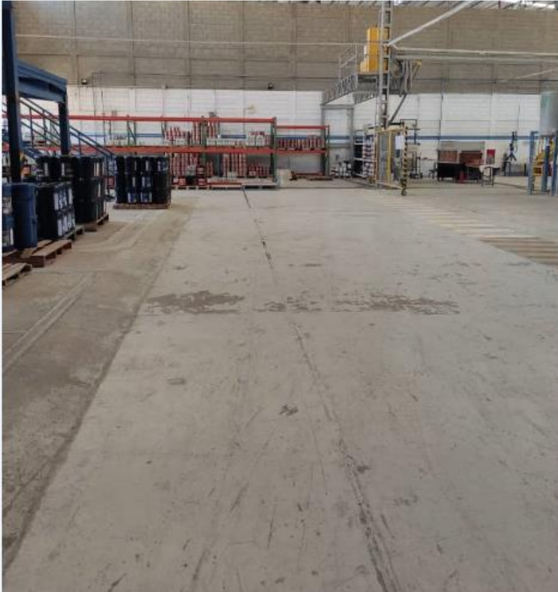
Figura 18 Falta de delimitaciones en el almacén de Inversiones PintaPro, C.A.
