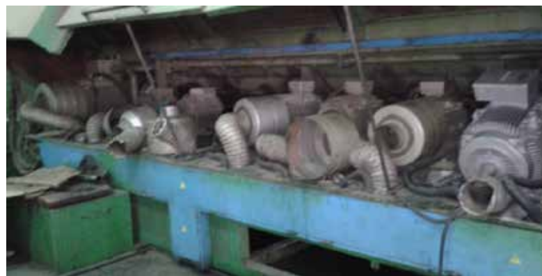
Figura 4: Motores defectuosos de trefiladora Fuente: Elaboración propia (2017)
