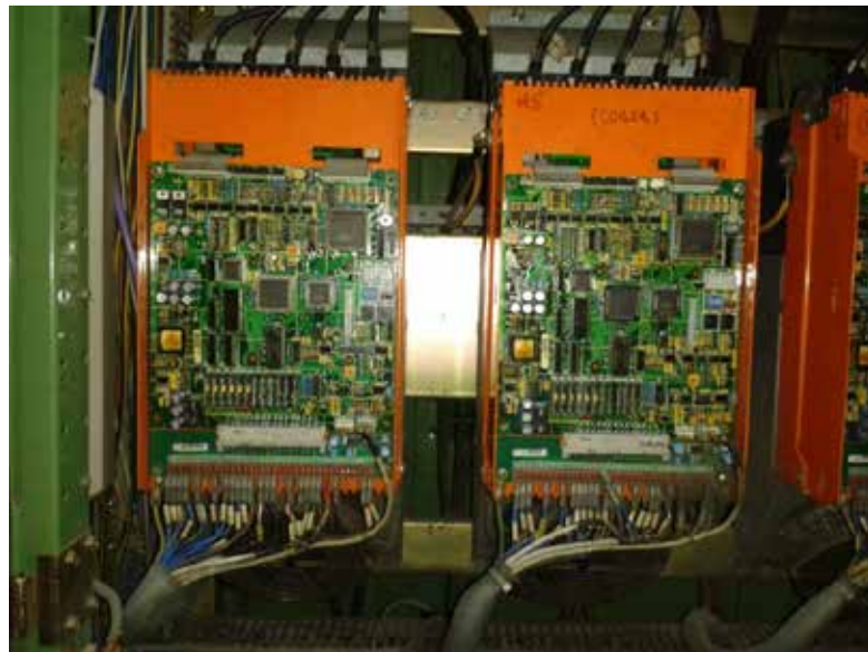
Figura 14: inversores / DC- AC Fuente: Elaboración propia (2017)
