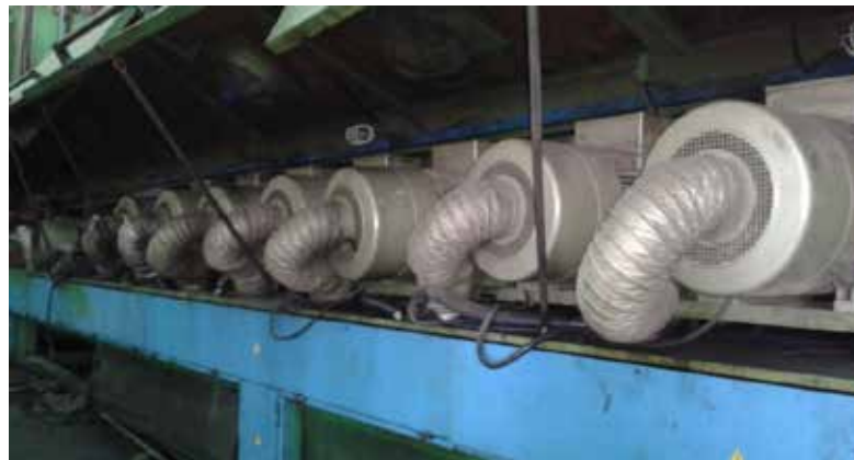
Figura 3: Motores AC de trefiladora Fuente: Elaboración propia (2017)
