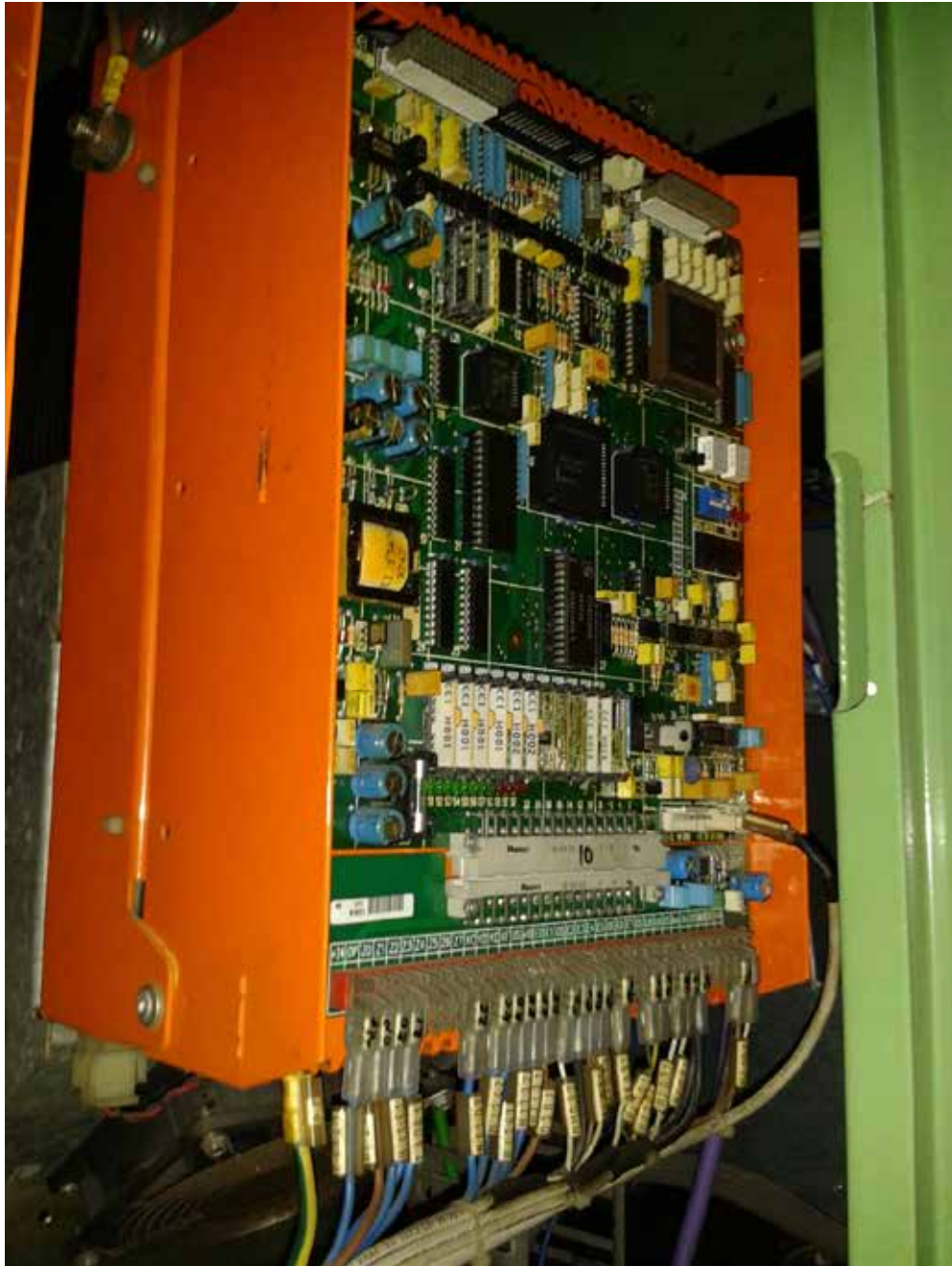
Variador de frecuencia
