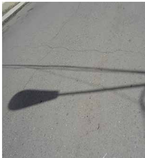
Falla 5: Falla Longitudinal y Piel de cocodrilo de 40.5x0.5m
