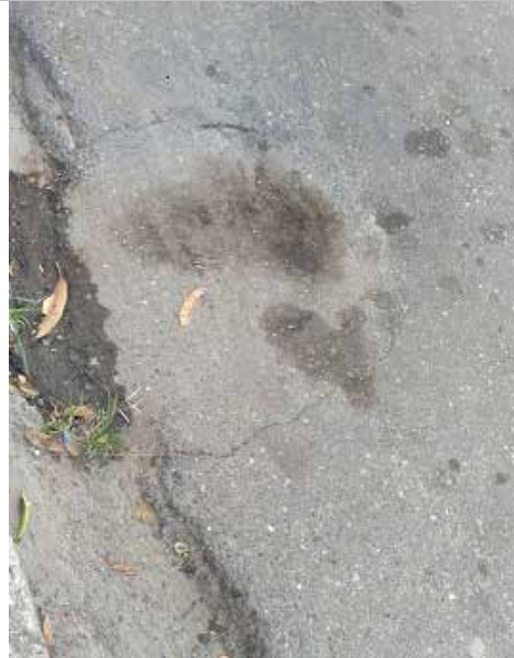
Falla 28: Hundimiento de 1x0.9x0.05m Fuente: Crialese I., Capuzzi L. (2019)
