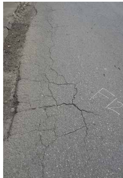
Falla 12: Falla de borde y piel de
