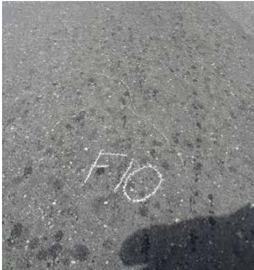
Falla 10: Falla longitudinal de 14.20x0.3m Fuente: Crialese I., Capuzzi L. (2019)
