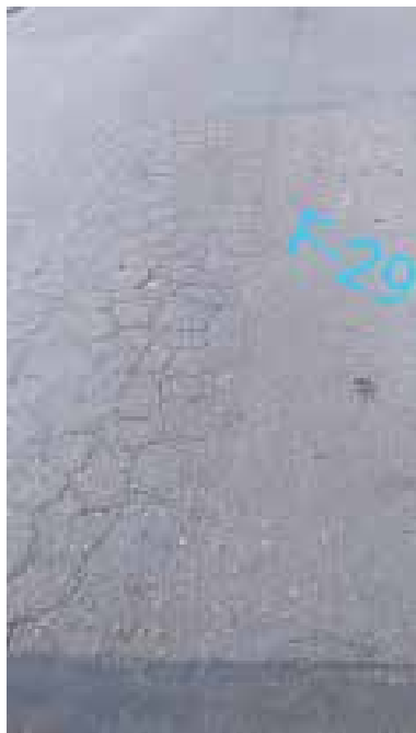
Falla 29: Piel de cocodrilo y falla longitudinal de 63.5x1m Fuente: Crialese I., Capuzzi L. (2019)
