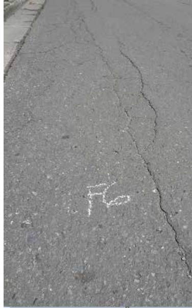
Falla 6: Falla de Borde de 25x1.1x1.10m Fuente: Crialese I., Capuzzi L. (2019)
