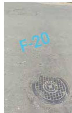
Falla 20: Falla en boca y longitudinal de 0.6x0.7x0.19m Fuente: Crialese I., Capuzzi L. (2019)
