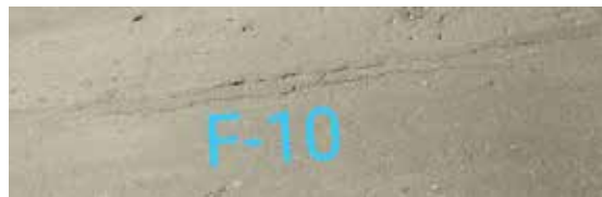
Falla 10: Falla longitudinal de 62.9x1m Fuente: Crialese I., Capuzzi L. (2019)
