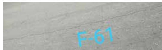
Falla 61: Falla transversal de 4x0.2m Fuente: Crialese I., Capuzzi L. (2019)
