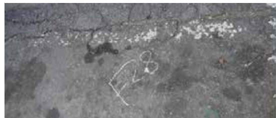
Falla 28: Falla longitudinal de 6.8x2m Fuente: Criaiese I., Capuzzi L. (2019)
