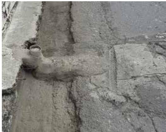
Ejemplo de cunetas obstruidas por tuberías. Fuente: Crialese I., Capuzzi L. (2019)
