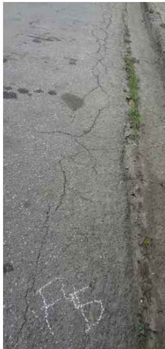
Falla 5: Falla de Borde y Piel de cocodrilo de 9x0.5m Fuente: Crialese I., Capuzzi L. (2019)
