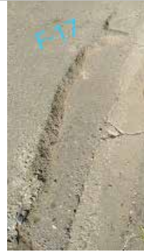
Falla 16: Piel de cocodrilo, falla longitudinal y de borde de 21x1.5m Fuente: Crialese I., Capuzzi L. (2019)
