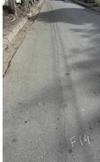
Falla 14: Falla longitudinal de 2.3x1.5m Fuente: Crialese I., Capuzzi L. (2019)
