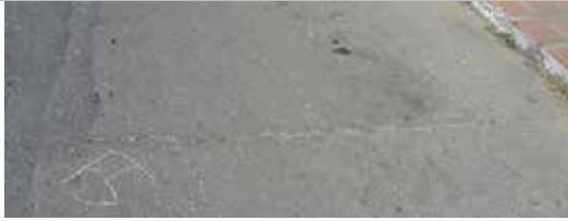
Falla 5: Falla transversal de 0.1x2.5m Fuente: Crialese I., Capuzzi L. (2019)
