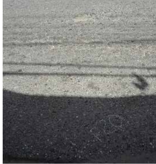
Falla 20: Falla longitudinal de 9.6x2m y bache de 40x30x4cm Fuente: Crialese I., Capuzzi L. (2019)
