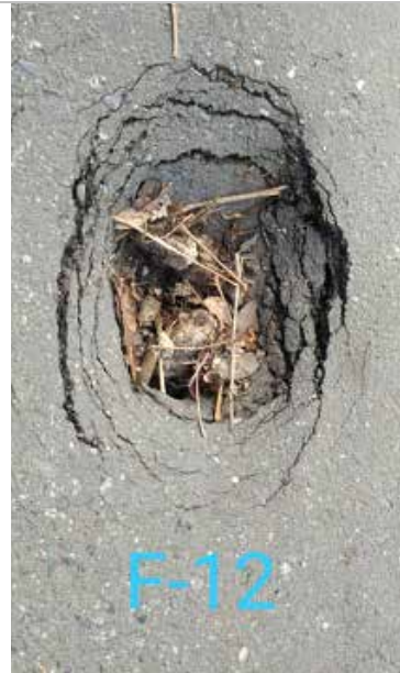
Falla 12: Bache de 0.6x0.7x0.19m
