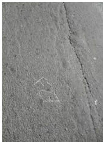
Falla 27: Descascaramiento de 6.5x5m Fuente: Criaiese I., Capuzzi L. (2019)
