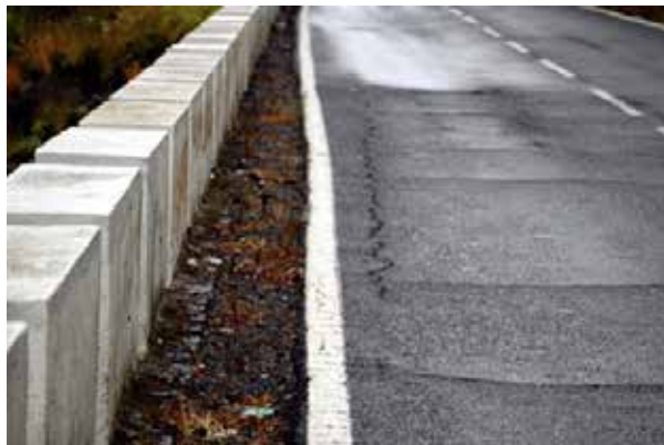
Figura 20. Fisura de borde.
