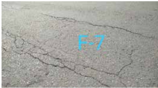
Falla 7: Hundimiento de 37x2x0.07m Fuente: Crialese I., Capuzzi L. (2019)
