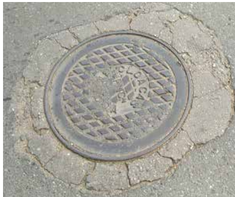
Falla 58: Falla en boca de 1.4x1.4m Fuente: Crialese I., Capuzzi L. (2019)
