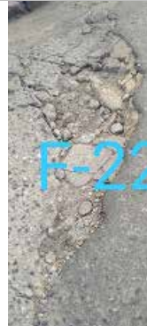
Falla 22: Falla de borde de 2.6x2.2x0.15m Fuente: Criaiese I., Capuzzi L. (2019)
