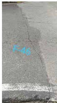
Falla 46: Falla transversal de 0.20x5.3m Fuente: Crialese I., Capuzzi L. (2019)
