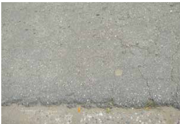
Falla 3: Hundimiento de 3.3x2.9x0.09m Fuente: Crialese I., Capuzzi L. (2019)
