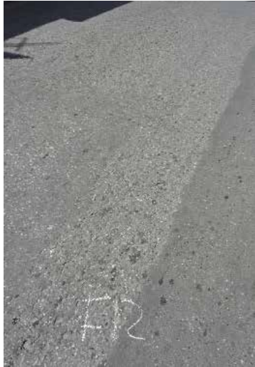
Falla 12: Descascaramiento de 3x4.4m Fuente: Crialese I., Capuzzi L. (2019)
