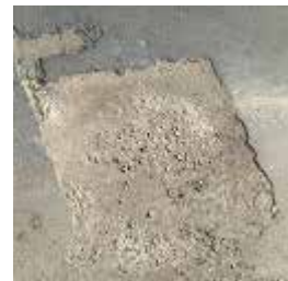
Falla 14: Hundimiento de 0.9x1.1x0.04m
