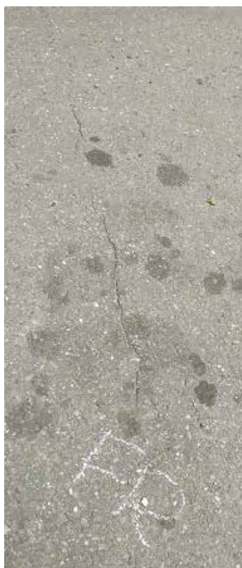
Falla 12: Falla transversal de 0.2x5.8m Fuente: Crialese I., Capuzzi L. (2019)
