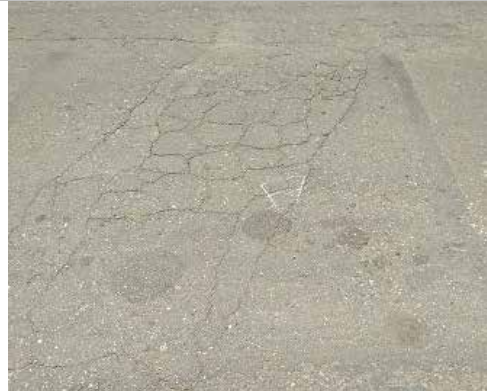
Falla 7: Hundimiento de 1.8x1.8m
