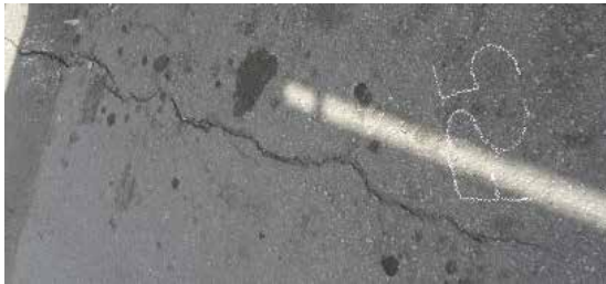
Falla 25: Falla longitudinal de 25x0.1m Fuente: Criaiese I., Capuzzi L. (2019)
