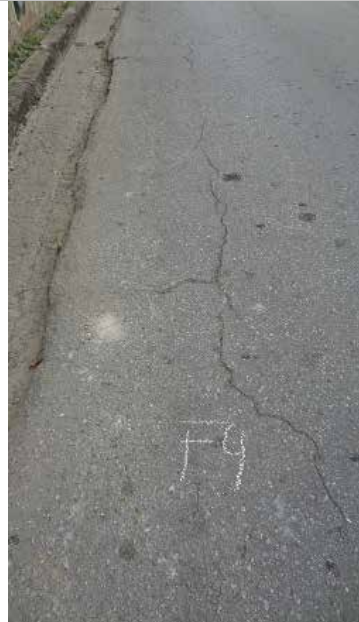
Falla 4: Falla longitudinal de 14.1x0.1m Fuente: Crialese I., Capuzzi L. (2019)
