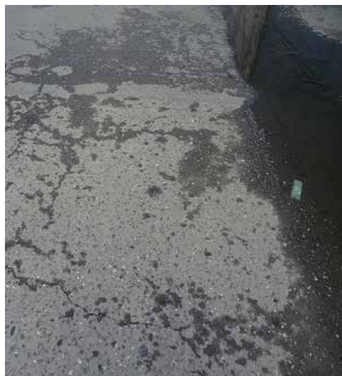
Falla 9: Falla transversal con piel de cocodrilo de 2.7x1.55m, se observa como el agua se estanca debido al deterioro del brocal
