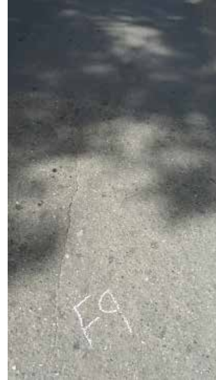
Falla 9: Falla longitudinal de 32x0.9m Fuente: Crialese I., Capuzzi L. (2019)
