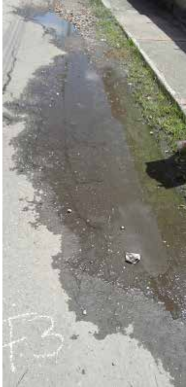
Falla 3: Falla de borde de 8x1.3m
