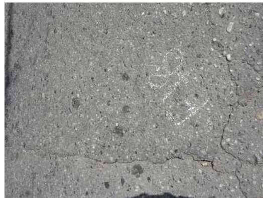
Falla 18: Falla transversal de 0.2x5.8m
