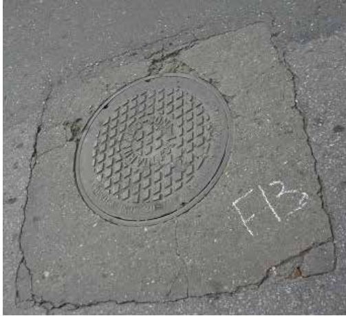
Falla 13: Falla en boca de 1.20x1.20m Fuente: Crialese I., Capuzzi L. (2019)
