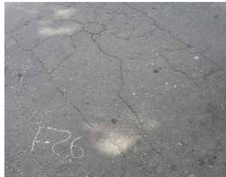
Falla 26: Piel de cocodrilo y abundamiento de 2.91x1.15m Fuente: Criaiese I., Capuzzi L. (2019)
