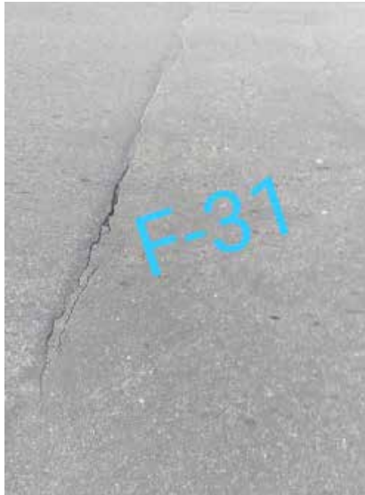
Falla 31: Falla transversal causada por los sumideros de ventana de 2x6.4m Fuente: Criaiese I., Capuzzi L. (2019)
