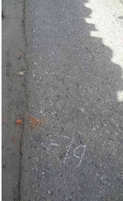
Falla 19: Falla de borde de 4x1.1x0.04m Fuente: Crialese I., Capuzzi L. (2019)
