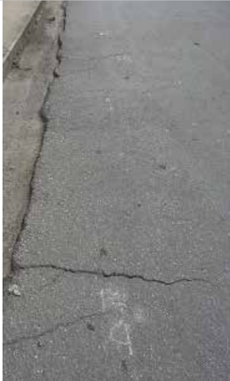
Falla 9: Falla mixta (longitudinal y transversal) de 2.4x1.15m Fuente: Crialese I., Capuzzi L. (2019)
