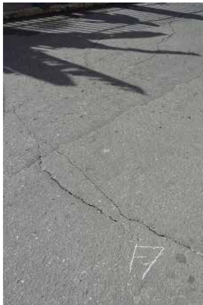
Falla 7: Falla transversal de 12.2x3.4m Fuente: Crialese I., Capuzzi L. (2019)
