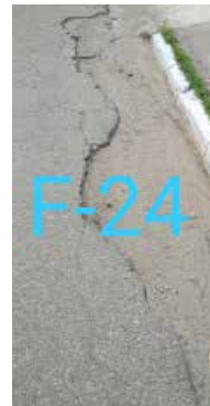
Falla 24: Falla de borde de 13x0.5m Fuente: Criaiese I., Capuzzi L. (2019)
