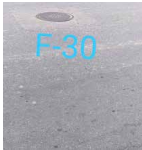
Falla 30: Falla en parche de 1.4x1.4m Fuente: Crialese I., Capuzzi L. (2019)
