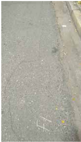
Falla 1: Falla longitudinal de 31x1m Fuente: Crialese I., Capuzzi L. (2019)
