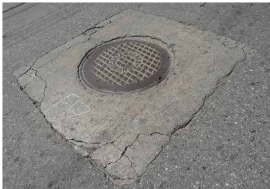
Falla 17: Falla en boca de 1.35x1.35m Fuente: Crialese I., Capuzzi L. (2019)
