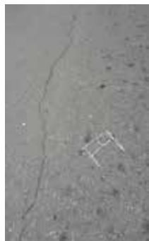
Falla 1: Falla Longitudinal de 15x0.05m
