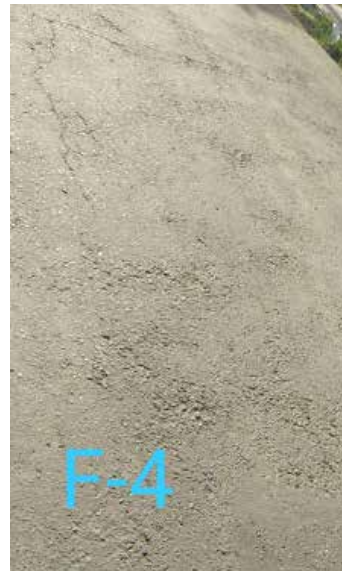
Falla 4: Descascaramiento de 3.3x3.3m Fuente: Crialese I., Capuzzi L. (2019)
