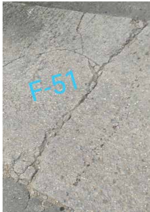
Falla 51: Falla longitudinal de 2x0.2m Fuente: Crialese I., Capuzzi L. (2019)
