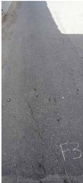
Falla 3: Falla longitudinal y piel de cocodrilo de 23.9x1m Fuente: Crialese I., Capuzzi L. (2019)
