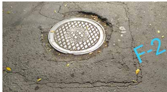
Falla 2: Falla en boca de 0.4x0.4m
