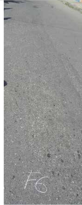
Falla 6: Falla longitudinal de 14.2x0.1m Fuente: Crialese I., Capuzzi L. (2019)
