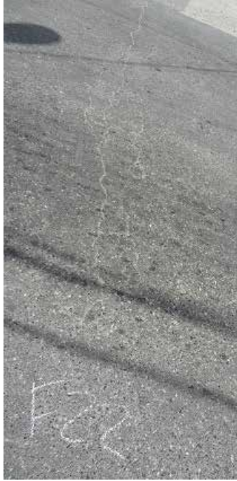
Falla 22: Falla transversal de 0.2x5.8m Fuente: Crialese I., Capuzzi L. (2019)
