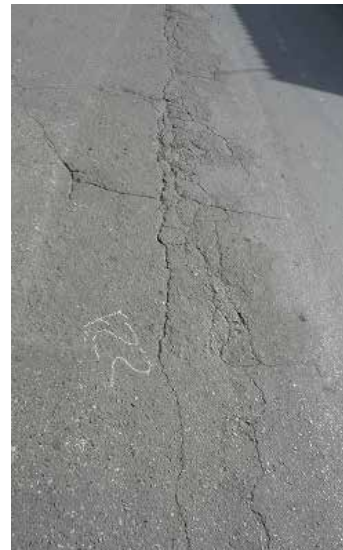
Falla 22: Falla longitudinal y piel de cocodrilo de 28x1.5m Fuente: Crialese I., Capuzzi L. (2019)
