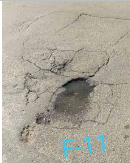
Falla 11: Bache y hundimiento de 2.2x3x0.05m
