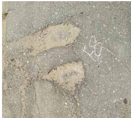
Falla 8: Bache de 0.3x0.4x0.06m
