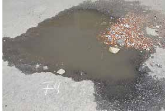
Falla 4: Bache de 2.3x2.3m
