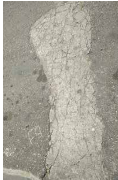
Falla 9: Hundimiento de 1x2.4x0.03m, además se aprecia la presencia de concreto sobre la capa asfáltica.
