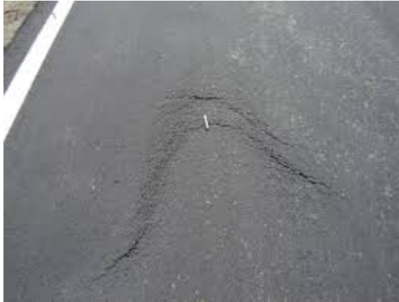
Figura 23. Fisura por deslizamiento de capas.
