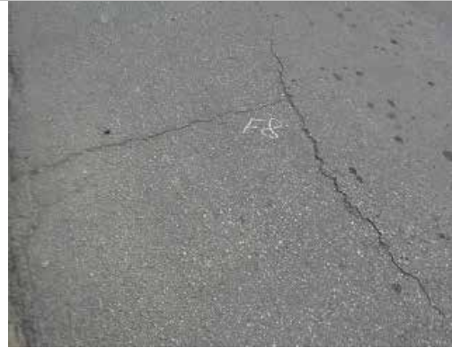
Falla 8: Falla mixta (longitudinal y transversal) de 2.4x1.15m Fuente: Crialese I., Capuzzi L. (2019)
