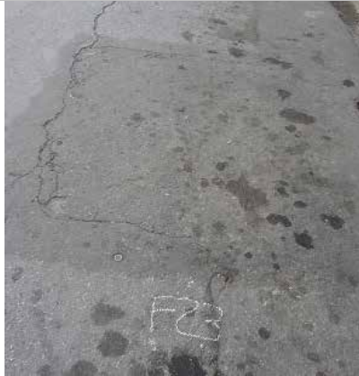
Falla 23: Fisura en parche de 1.8x1.02m Fuente: Criaiese I., Capuzzi L. (2019)
