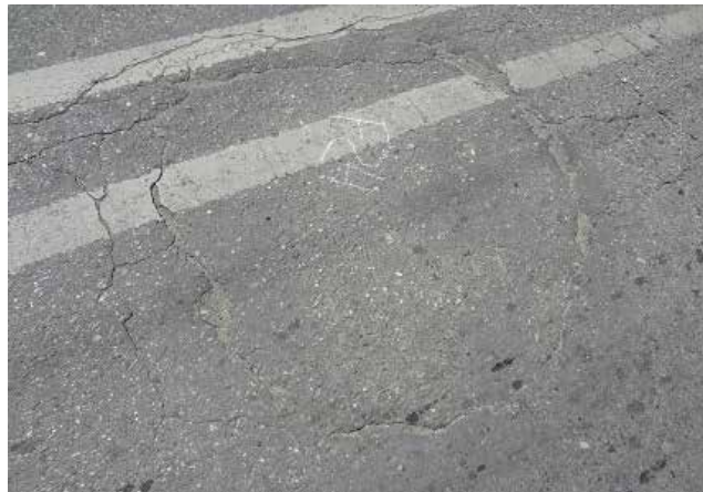
Falla 24: Falla en boca (la taparon) de 4x1.1x0.04m Fuente: Crialese I., Capuzzi L. (2019)
