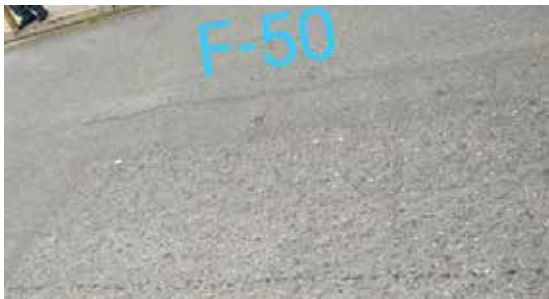
Falla 50: Falla longitudinal de 7x0.5m Fuente: Crialese I., Capuzzi L. (2019)
