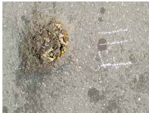
Falla 11: Falla en boca de 0.4x0.4x0.09m Fuente: Crialese I., Capuzzi L. (2019)
