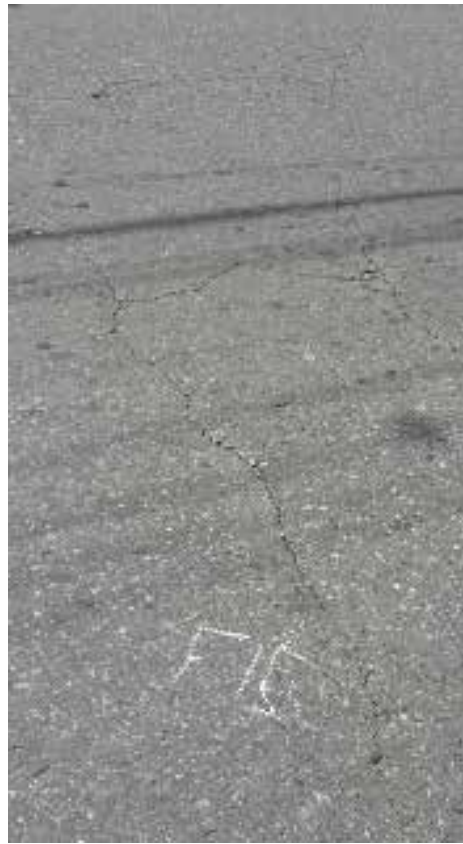
Falla 15: Falla transversal de 3.2x1.4m Fuente: Crialese I., Capuzzi L. (2019)
