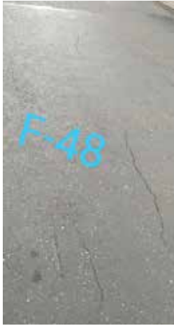
Falla 48: Falla longitudinal de 11x0.2m Fuente: Crialese I., Capuzzi L. (2019)
