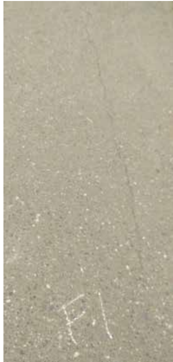
Falla 1: Piel de cocodrilo y falla longitudinal de 79x2.9m Fuente: Crialese I., Capuzzi L. (2019)
