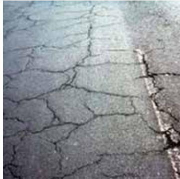
Figura 21. Fisura en bloque.
