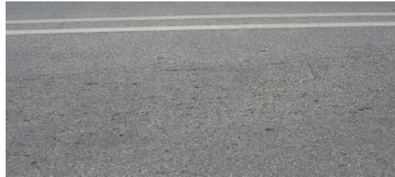
Falla 26: Hundimiento de 2x2.95x0.1m Fuente: Crialese I., Capuzzi L. (2019)
