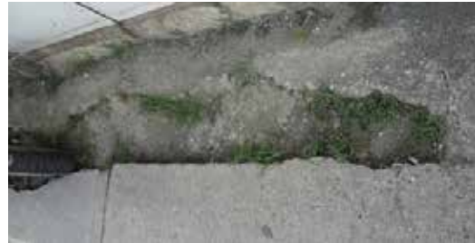
Se puede apreciar el daño grave en la acera. Fuente: Crialese I., Capuzzi L. (2019)
