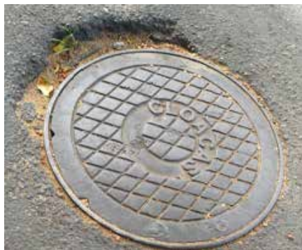
Falla 9: Falla en boca de 0.9x0.9x0.05m Fuente: Crialese I., Capuzzi L. (2019)
