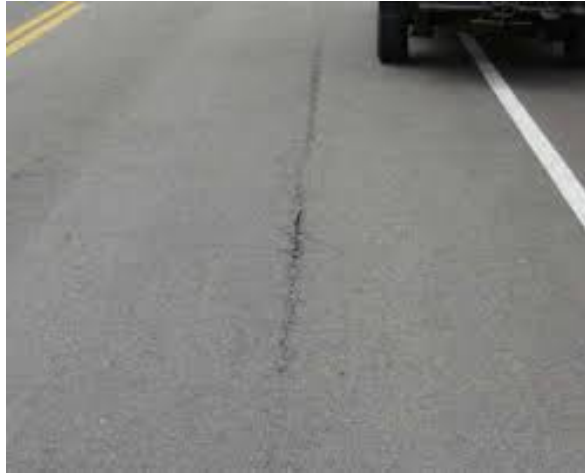
Figura 19. Fisura en junta.
