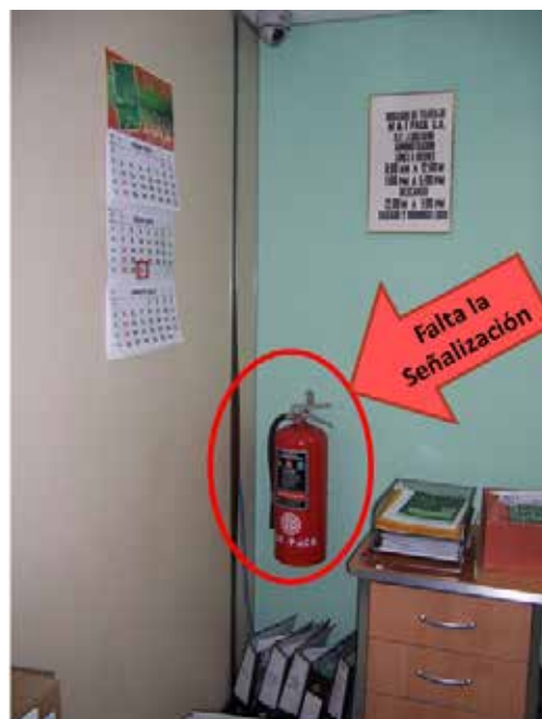
Figura 7. Falta de señalización Autor: Sánchez, M. (2019)
