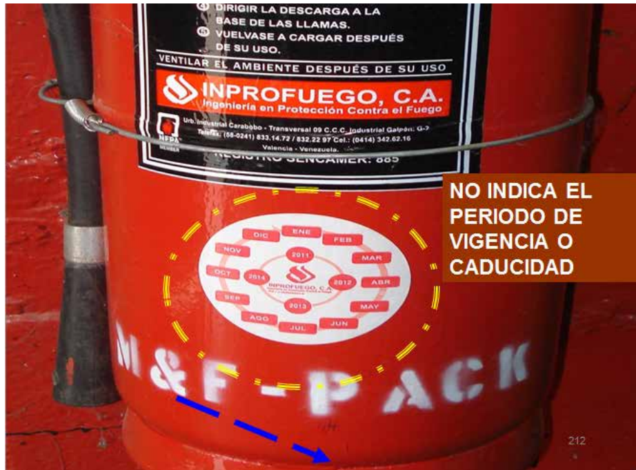
Figura 6. Falta de verificación de las fechas de caducidad de los extintores. Autor: Sánchez, M. (2019)
