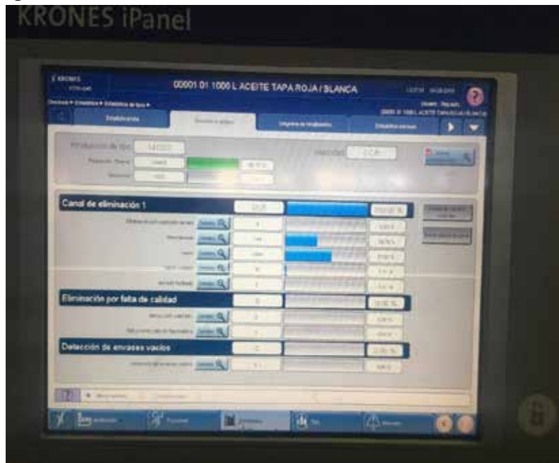
Figura 11. Pantalla de Checkmat después de la Etapa de la Llenadora
