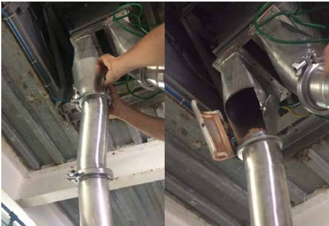
Figura 14. Tubería de Llenado Actual Fuente: Estrada, O y Sthory, G. (2017)
