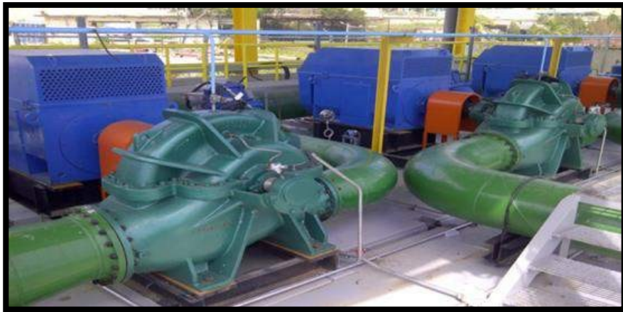
Figura 18. Bombas ubicadas en la gabarra
