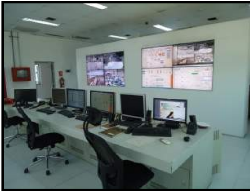
Figura 26. Sala de control
