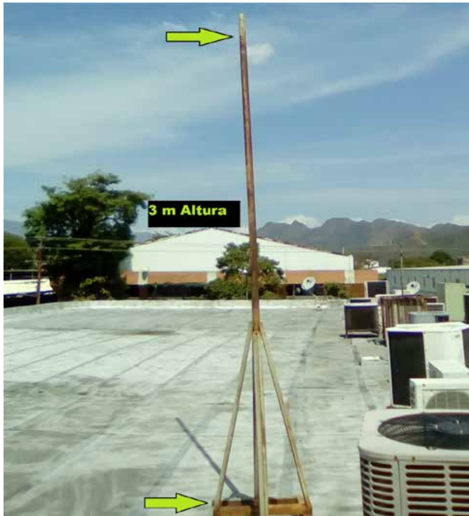
Figura 12. Mástil antena sede principal.
