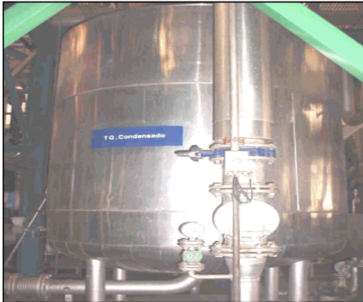
Figura 7: Tanque de condensado
