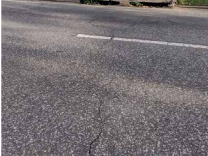
Figura 53: Grietas longitudinales y transversales
