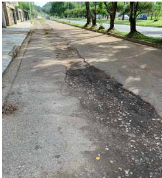
Figura 98: Grieta longitudinal y transversal
