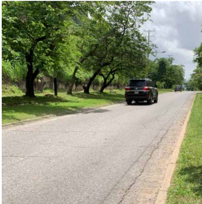
Figura 76: Grietas longitudinales transversal
