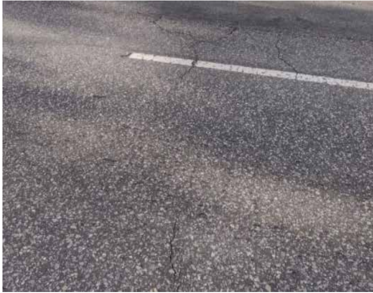
Figura 63: Grieta longitudinal y transversal
