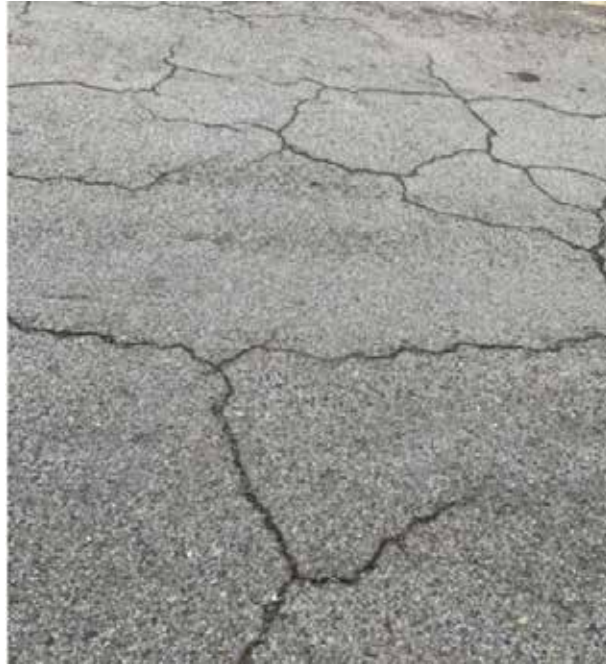
Figura 55: Grietas longitudinales y transversales
