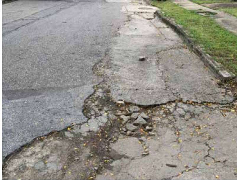
Figura 91: Falla de borde
