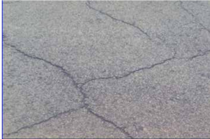
Figura 10: Grietas de contracción (bloque)
