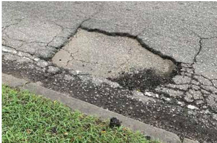
Figura 52: Falla de borde
