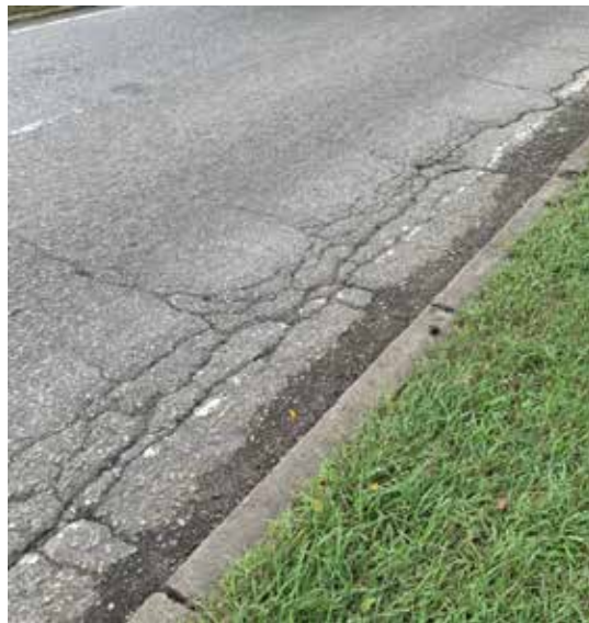
Figura 46: Grietas longitudinales y transversales
