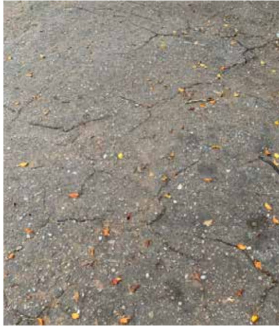
Figura 79: Grietas longitudinales y transversales
