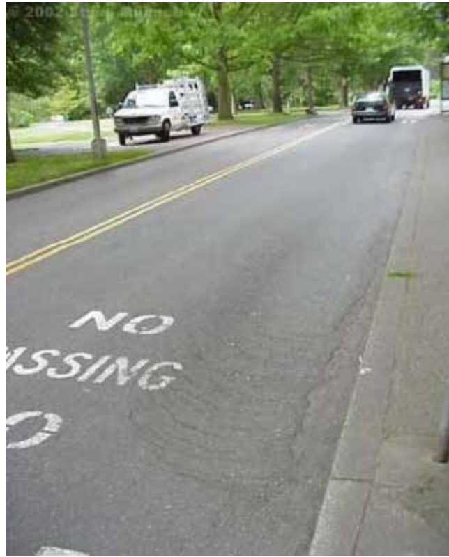
Figura 24: Grietas de desplazamiento
