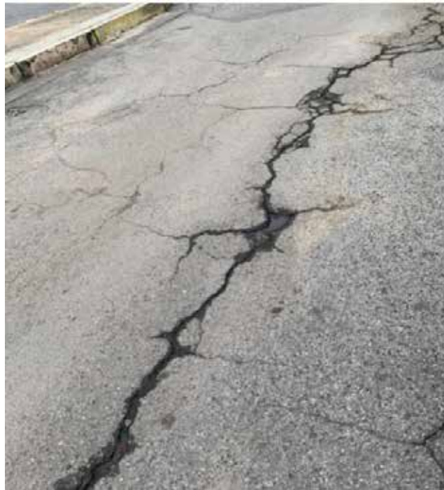
Figura 84: Grietas longitudinales y transversales
