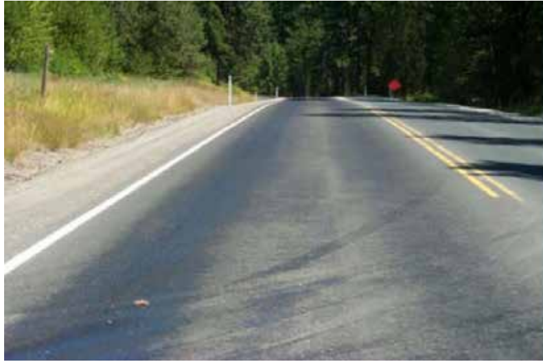
Figura 9: Mancha en pavimento (exudación)
