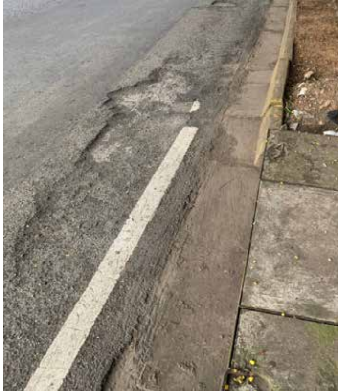
Figura 59: Falla de borde
