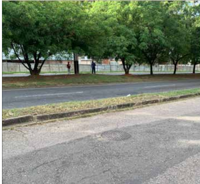
Figura 89: Grieta longitudinal y transversal
