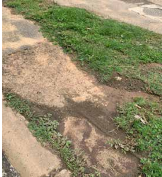
Figura 99: Falla de borde
