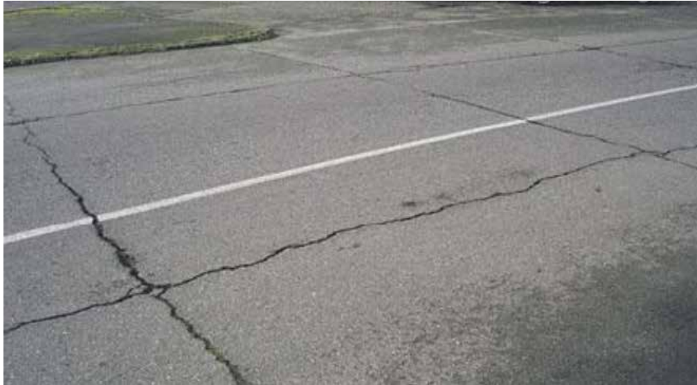
Figura 15: Grieta de reflexión de juntas de losas de concreto
