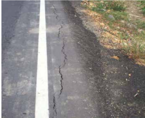
Figura 14: Grieta de borde
