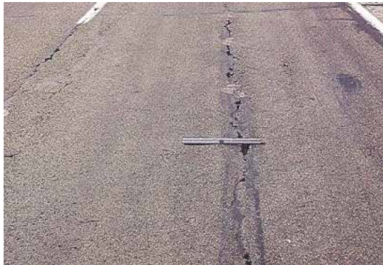
Figura 17: Grietas longitudinales y transversales
