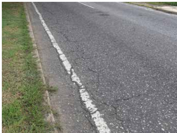
Figura 60: Grietas longitudinales y transversales
