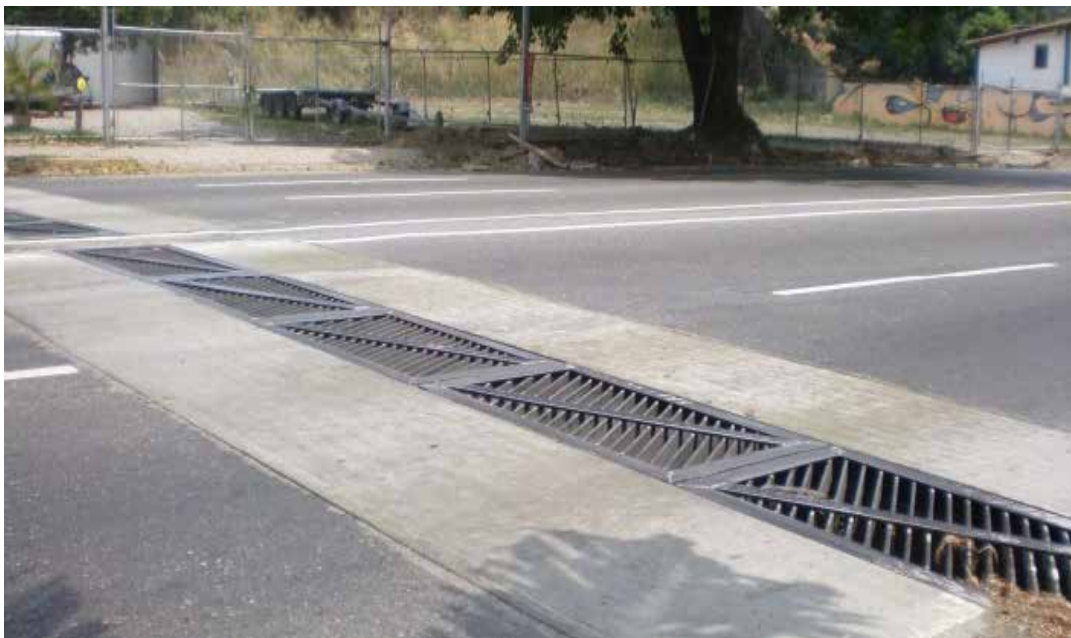
Figura 21: Cruce de sumideros de rejilla
