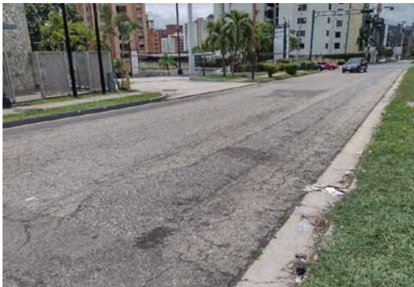
Figura 92: Grieta longitudinal y transversal
