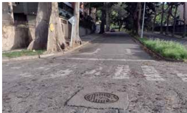
Figura 120: Demarcación deteriorada Fuente: Bernstein B, Peña I. (2021)
