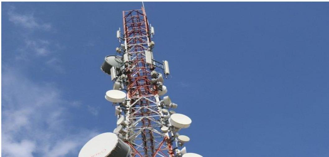
Figura 5: Infraestructura de Radio Base para Red 4G LTE en Caracas
