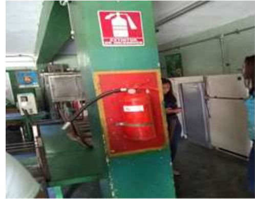
Figura 15: señalización de equipo de extinción contra incendios Autor: Losavio, Sánchez. (2020)
