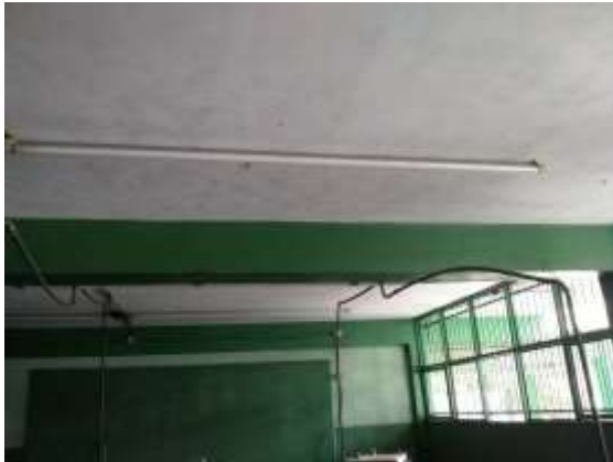
Figura 1. Vista de las condiciones cómo esta sujetado el cableado. Autor: Sánchez, Losavio (2019)
