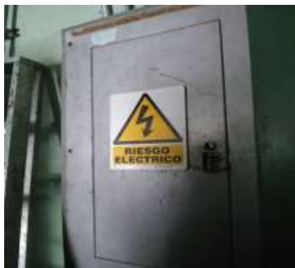
Figura 18: Señalización de riesgo Eléctrico Autor: Losavio, Sánchez. (2020)
