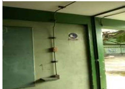
Figura 17: Señaliza con del uso de equipos de seguridad Autor: Losavio, Sánchez. (2020)
