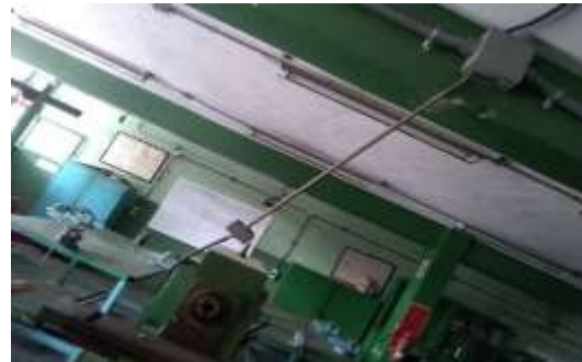
Figura 4. Vista de las instalaciones del cableado de las maquinas de Torno. Autor: Sánchez, Losavio (2019)
