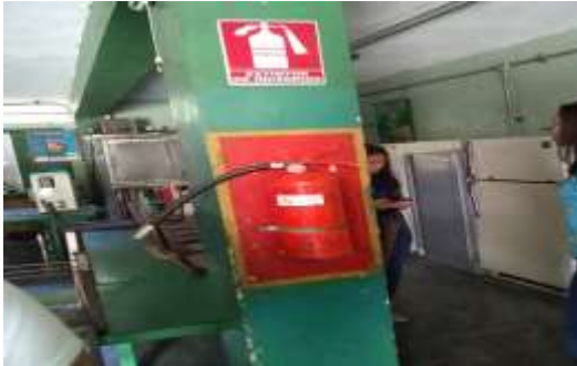
Figura 7. Señalización de equipos de extinción de incendios. Autor: Sánchez, Losavio (2019)
