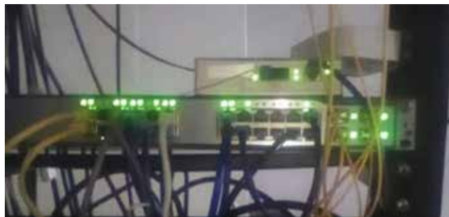
Figura 30: Switch Cisco WS-C3750G-24TS-1U con el cual se administra la red de Conex Telecom en Cerro Copey
