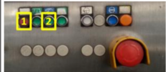
Imagen #4. Tablero control de mando del paletizador
