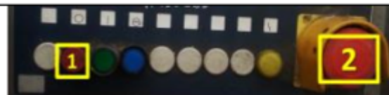
Imagen #9. Panel de control vía transportadora de empaques
