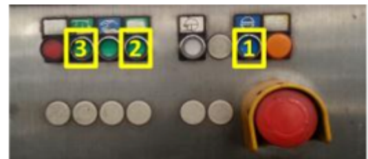
Imagen #3. Tablero de control del Paletizador
