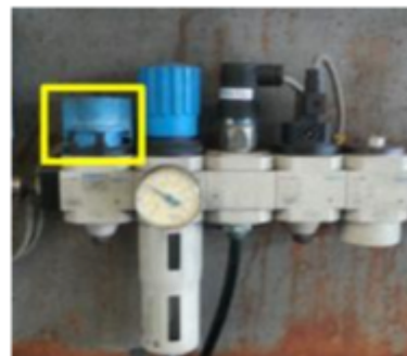
Imagen #16. Válvula principal de aire
