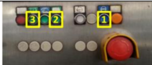
Imagen #5. Tablero de control del Paletizador
