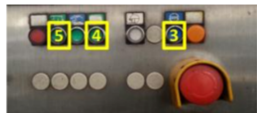
Imagen #7. Tablero control de mando del paletizador
