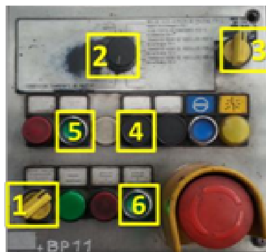
Imagen#17. Tablero control de mando del Desarmador
