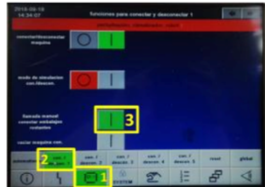
Imagen #2. Tablero de control vía empaques
