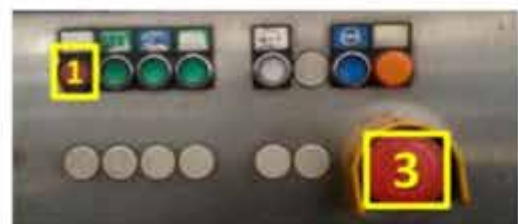
Imagen #4. Panel de control paletizador
