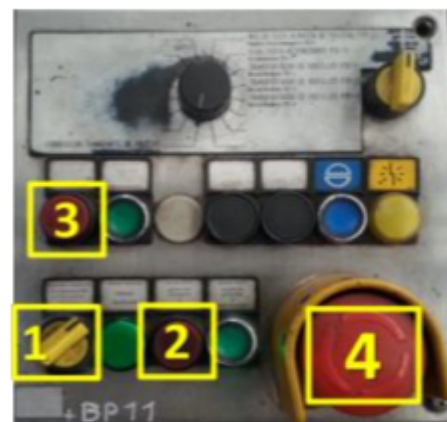
Imagen #11. Tablero control de mando del Desarrumador
