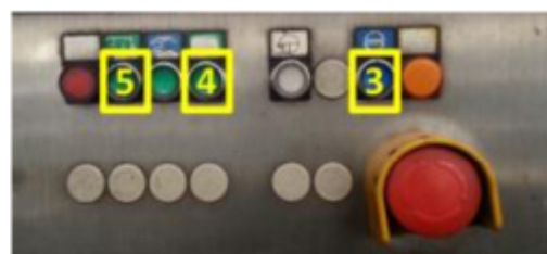
Imagen #10. Tablero control de mando del paletizador
