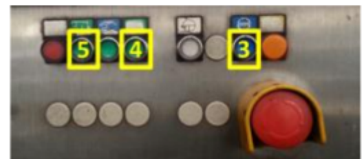
Imagen #14. Tablero control de mando del paletizador
