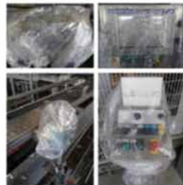
Imagen #3. Partes eléctricas protegidas
