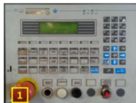
Imagen #12. Panel de control del Robopac
