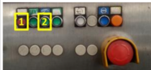
Imagen #8. Tablero control de mando del paletizador
