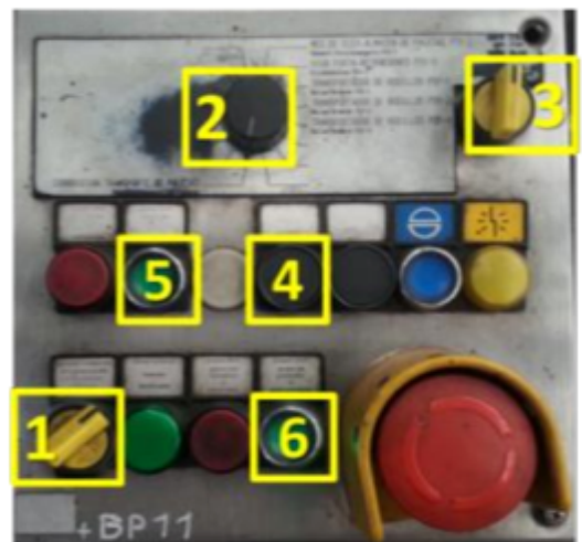
Imagen #3. Tablero control de mando del desarrumador
