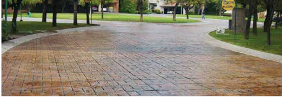
Figura 50: Acabado de cemento estampado. Fuente: https://blog.portaliaplus.com/2017/10/02/concreto-estampado-funcionalidad/
