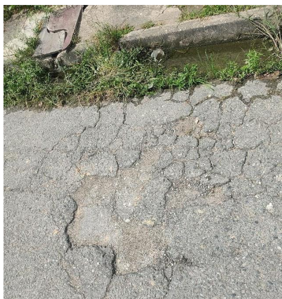
Figura 35: Fallas por borde y agrietamiento Fuente: Puerta – Chacón
