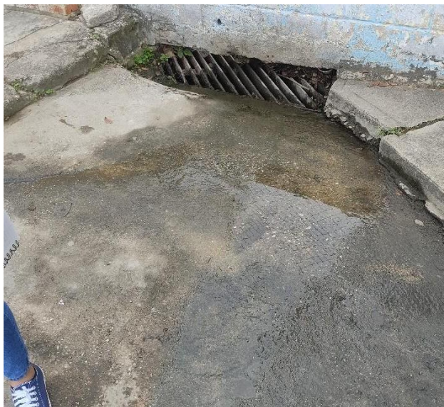
Figura 38: Desintegración del pavimento por acumulación de agua Fuente: Puerta – Chacón
