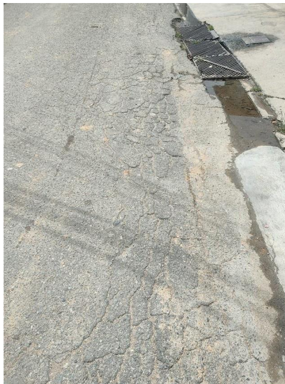
Figura 37: Fallas por borde y agrietamiento por contracción Fuente: Puerta – Chacón
