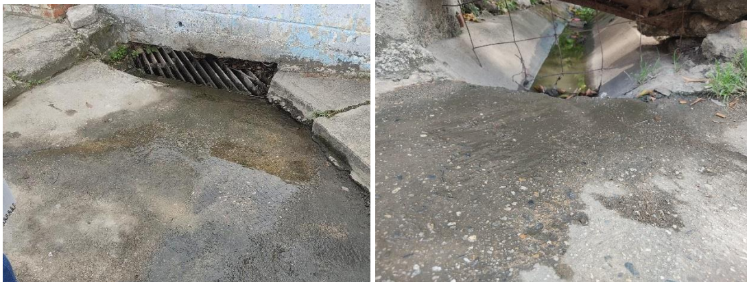
Drenajes de rejilla y canales atrofiados Fuente: Puerta y Chacón (2022)
