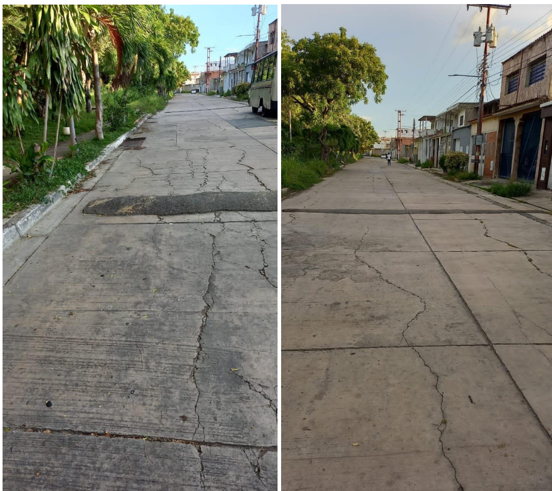
Grietas longitudinales Fuente: Puerta y Chacón (2022)
