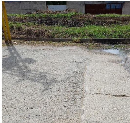
Figura 25: Piel de cocodrilo y falla por borde Fuente: Puerta – Chacón
