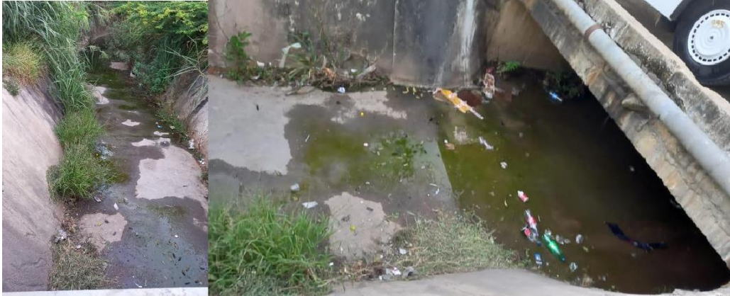
Figura 19: Collage – Sistema de drenaje deteriorado
