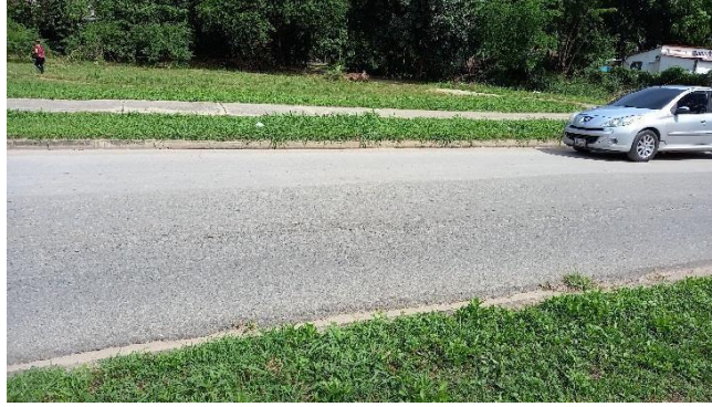
Figura 24: Grietas longitudinales Fuente: Puerta – Chacón
