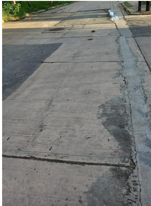
Figura 20: Collage – zanjas parcheadas a lo largo de la avenida
