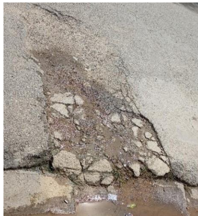
Figura 28: Fallas por borde y disgregación del material
