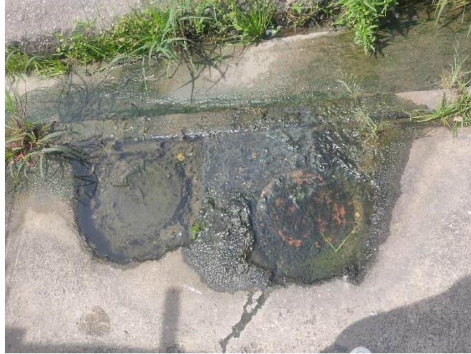
Figura 32: Fallas de servicio Fuente: Puerta – Chacón
