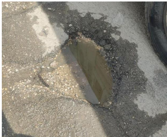
Figura 22: Huecos en el Pavimento Fuente: Puerta – Chacón
