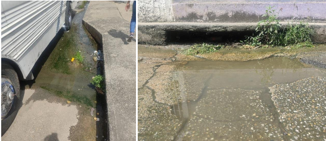
Falla por drenajes de ventana, Falta de mantenimiento Fuente: Puerta y Chacón (2022)
