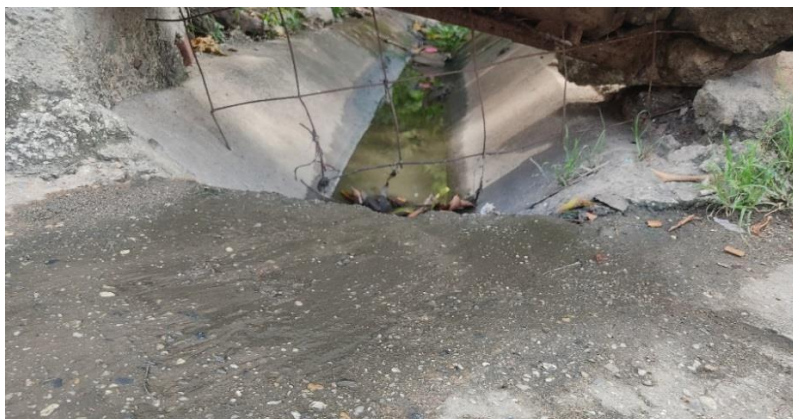
Figura 58: Drenaje alterado por los factores dañinos (tramo 7)
