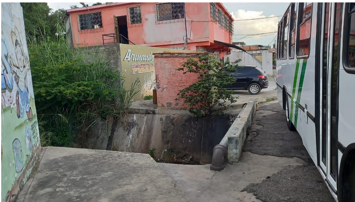
Figura 34: Sistema de drenaje con maleza (Falta de mantenimiento) Fuente: Puerta – Chacón
