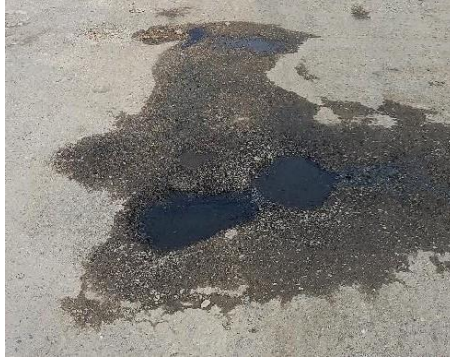
Figura 29: Huecos y acumulación de agua
