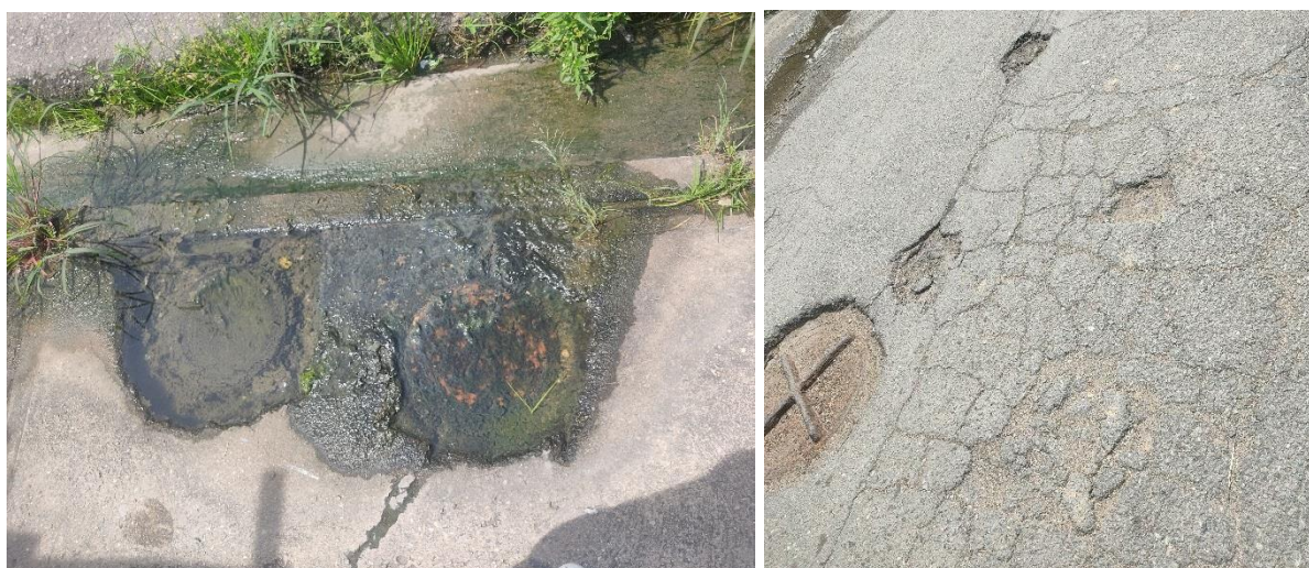
Falla por servicios
