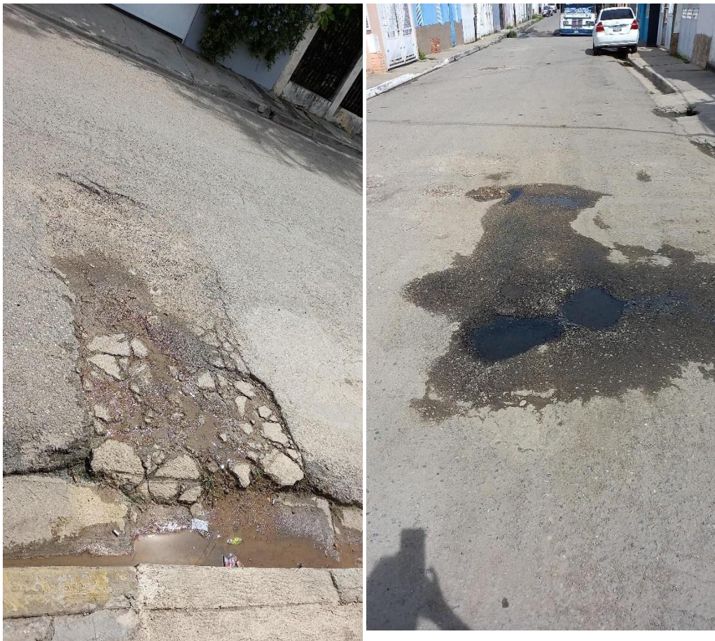
Falla por huecos y hundimientos Fuente: Puerta y Chacón (2022)
