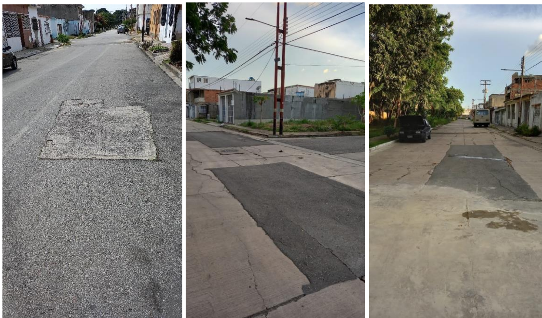
Falla de parcheo incorrecto para la vialidad
