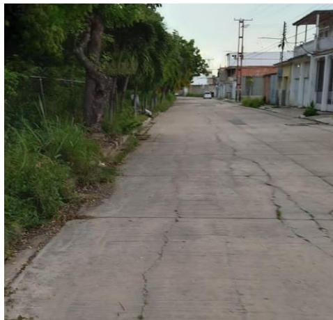
Figura 26: Maleza y Grietas en la vía Fuente: Puerta – Chacón
