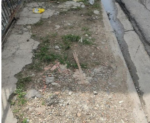
Figura 36: Disgregación y desintegración de la acera con falla por borde Fuente: Puerta – Chacón
