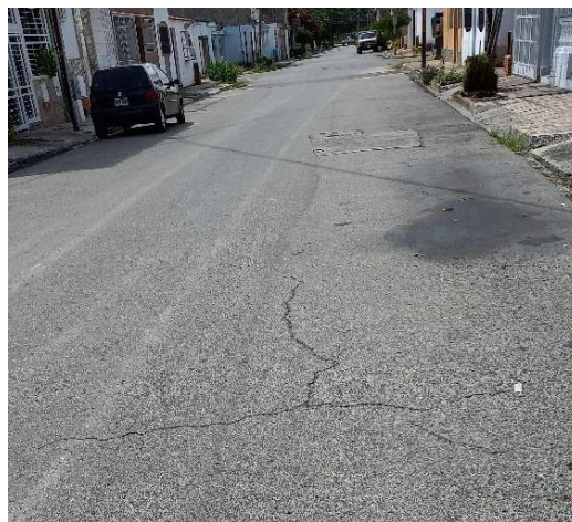
Figura 23: Grietas con manchas (exudación)
