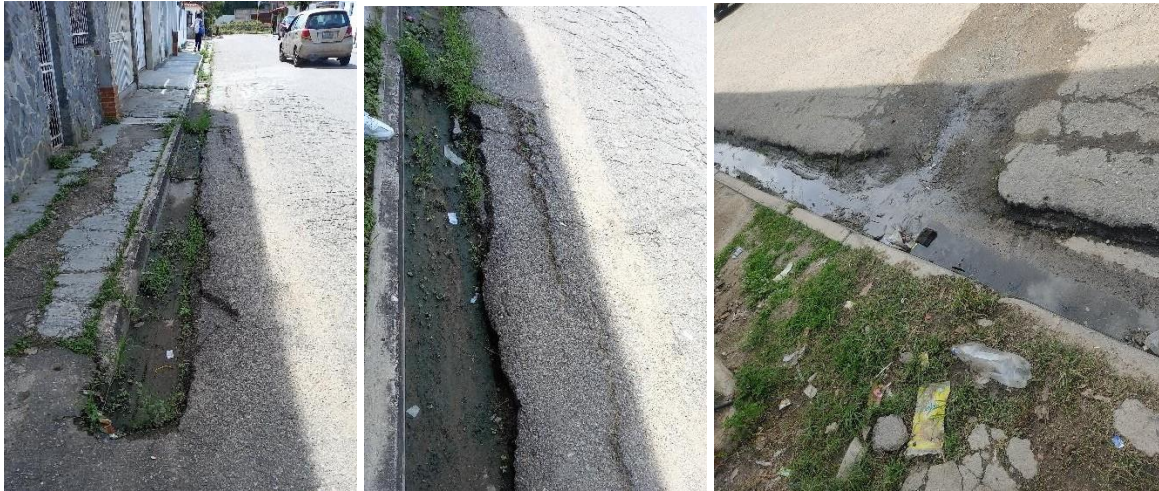
Falla por borde, desnivel calzada y hombrillo Fuente: Puerta y Chacón (2022)
