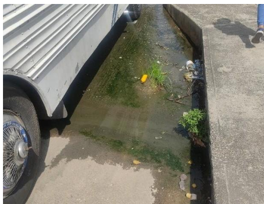
Figura 31: Agua empozada en drenajes de ventana defectuosos
