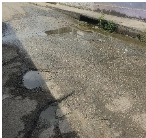
Figura 33: Huecos con agua acumulada y piel de cocodrilo Fuente: Puerta – Chacón
