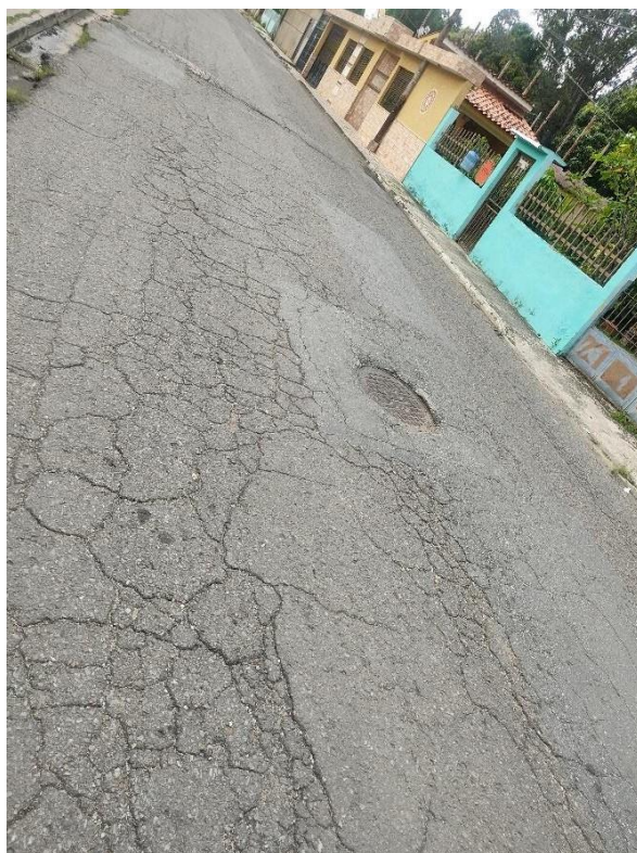
Figura 39: Agrietamiento en toda la extensión de la calzada Fuente: Puerta – Chacón
