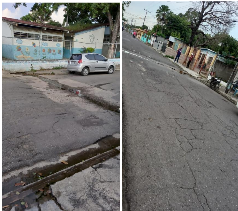
Aguas negras estancadas por mal funcionamiento de los sistemas de drenaje Fuente: Puerta y Chacón (2022)
