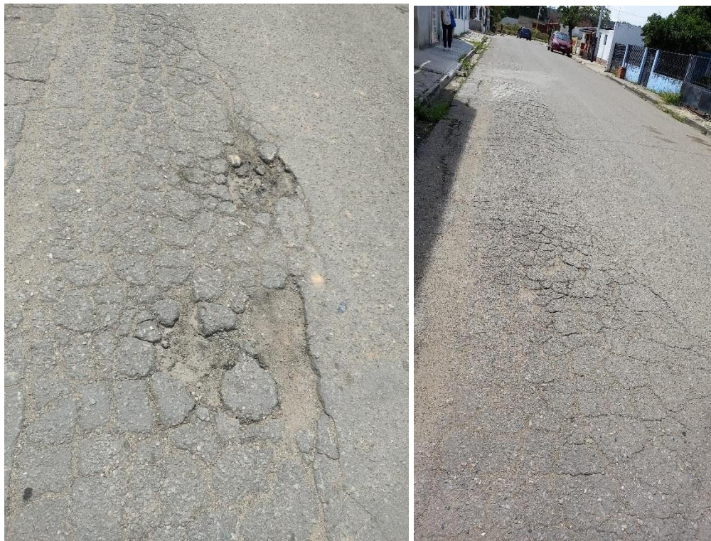
Falla por borde, Relación cuneta y calzada Fuente: Puerta y Chacón (2022)
