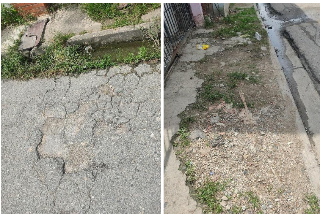
Falla por disgregación en las aceras
