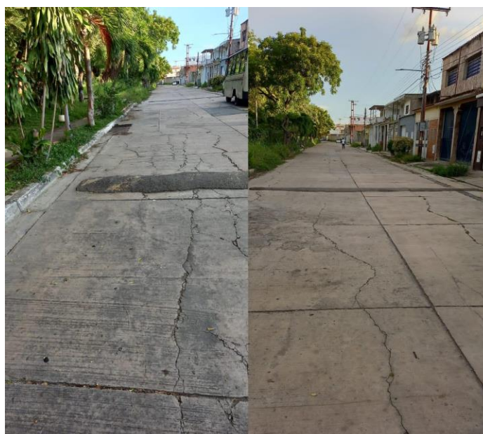
Figura 18: Collage –Grietas Longitudinales y reductores en mal estado
