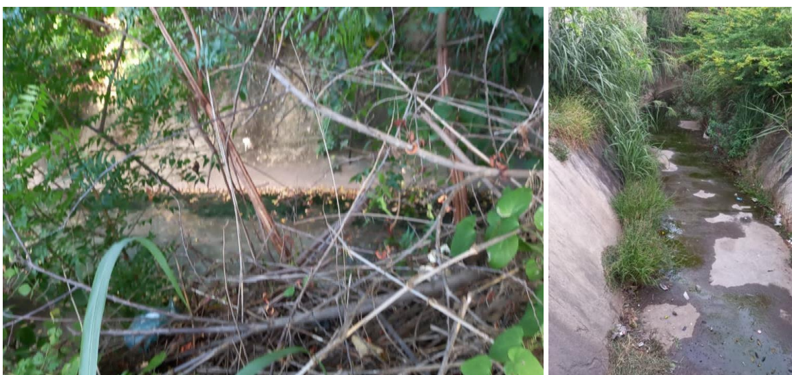
Falla por maleza y falta de limpieza
