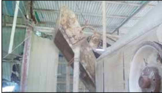
Figura 15. Entrada de mineral a la Criba Mogensen
