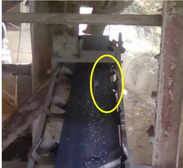
Figura 40. Vista superior del rompimiento de la cinta transportadora de retorno al molino
