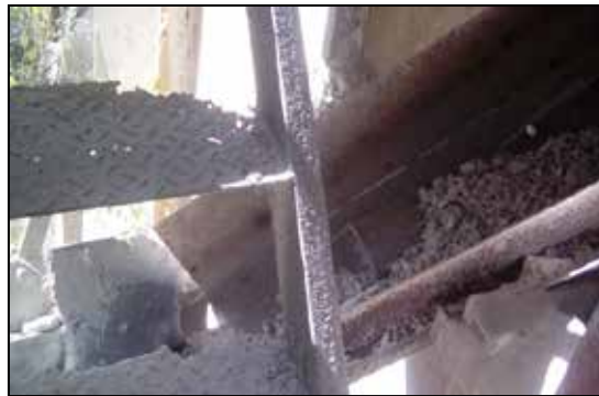
Figura 39. Estado de la Bandeja Fuente: Acuña, 2018
