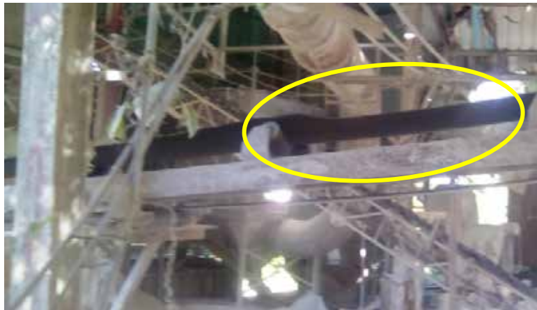
Figura 41. Vista lateral del rompimiento de la cinta transportadora de retorno al molino
