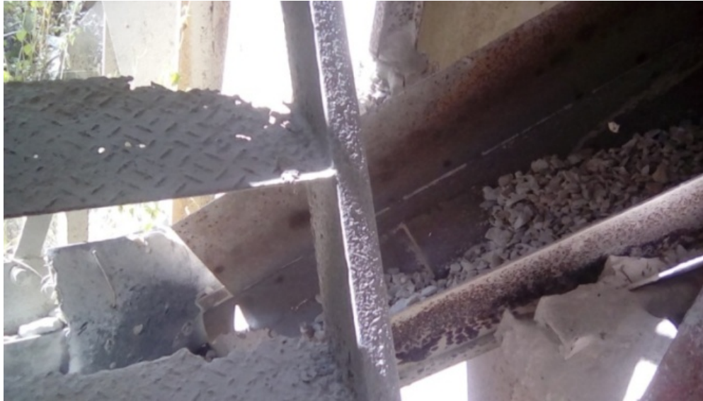
Figura 39. Deterioro de los componentes Fuente: Acuña, 2018
