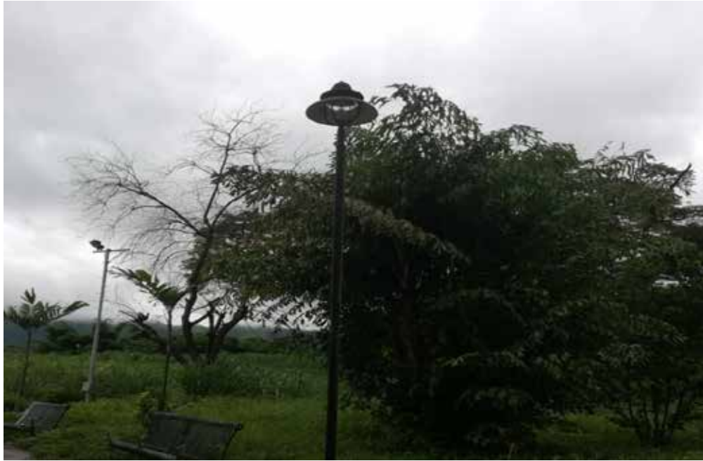
Figura 43 – Luminarias exteriores de la UJAP
