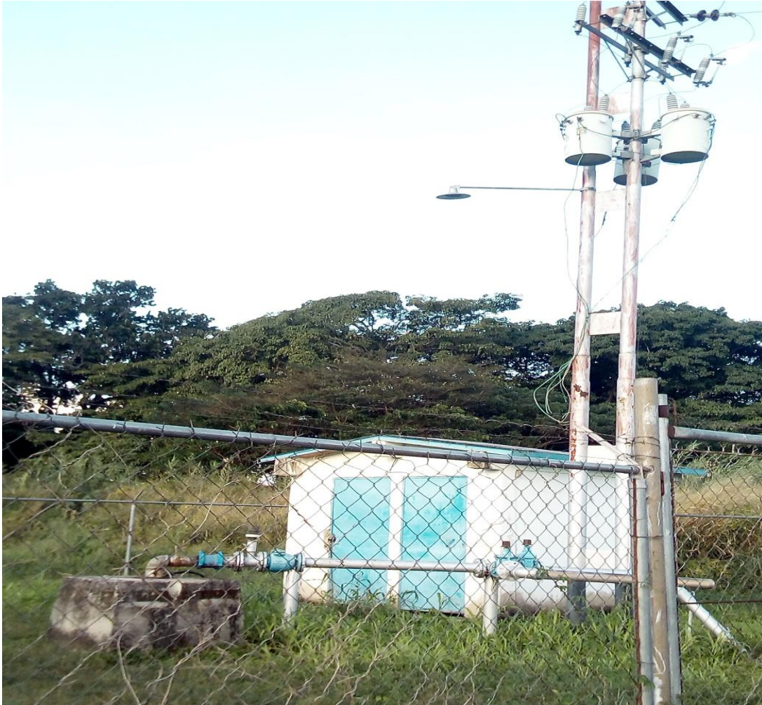
Figura 6. Caseta del pozo N° 87 y las instalaciones de distribución de agua. Fuente: Carvajal, J. (2021)
