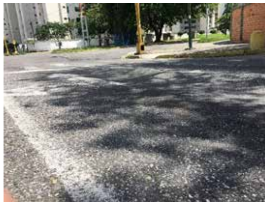
Figura 56: Falla de Ahuellamiento.
