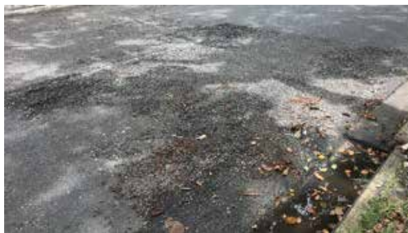
Figura 53: Pérdida del Agregado.
