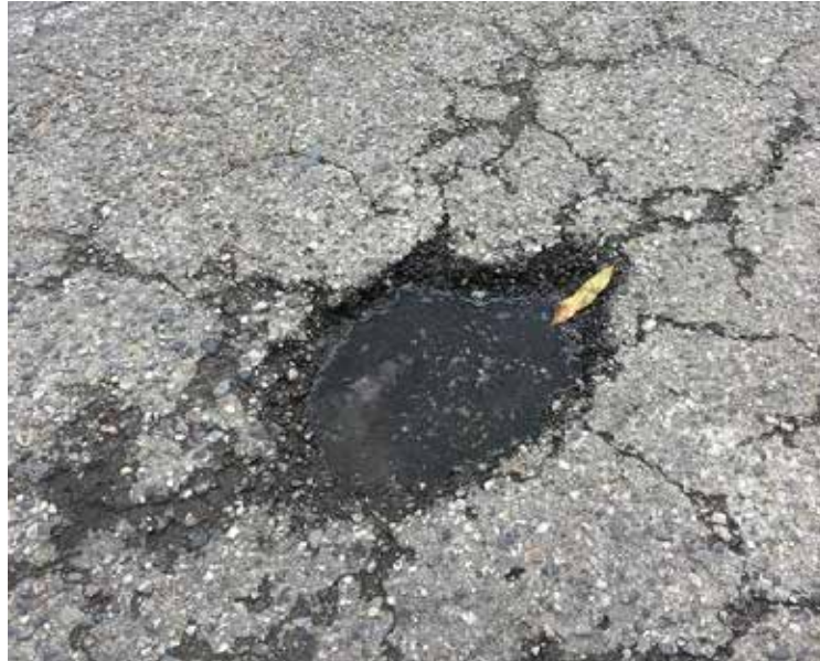
Figura 68: Fisura longitudinal con hueco.
