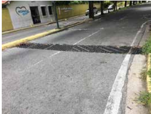
Figura 55: Sumidero de Rejilla.
