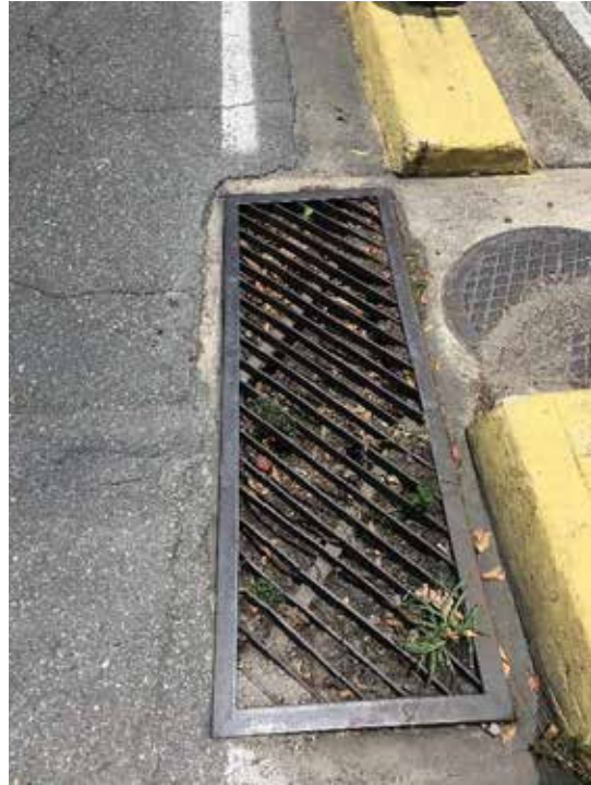
Figura 66: Sumidero de rejilla.
