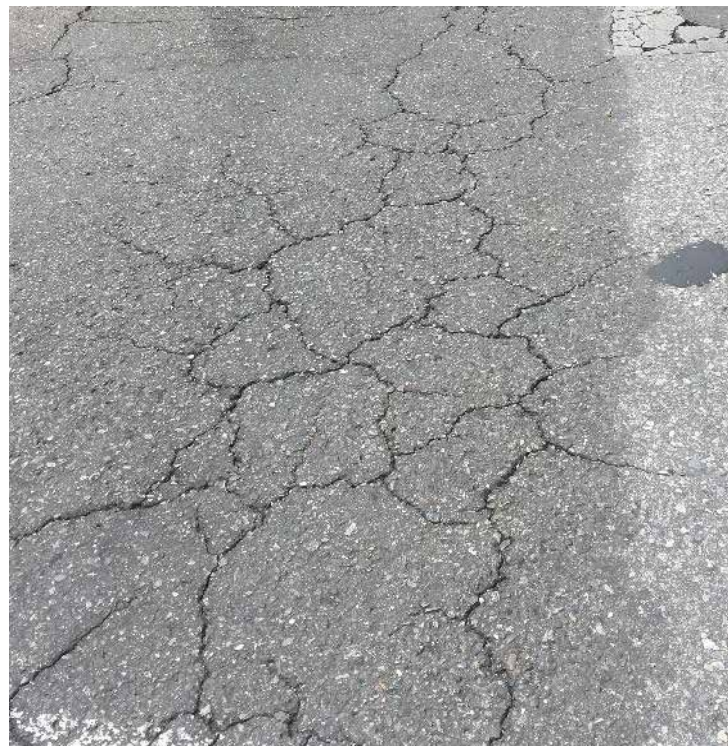
Figura 47: Falla Piel de Cocodrilo.
