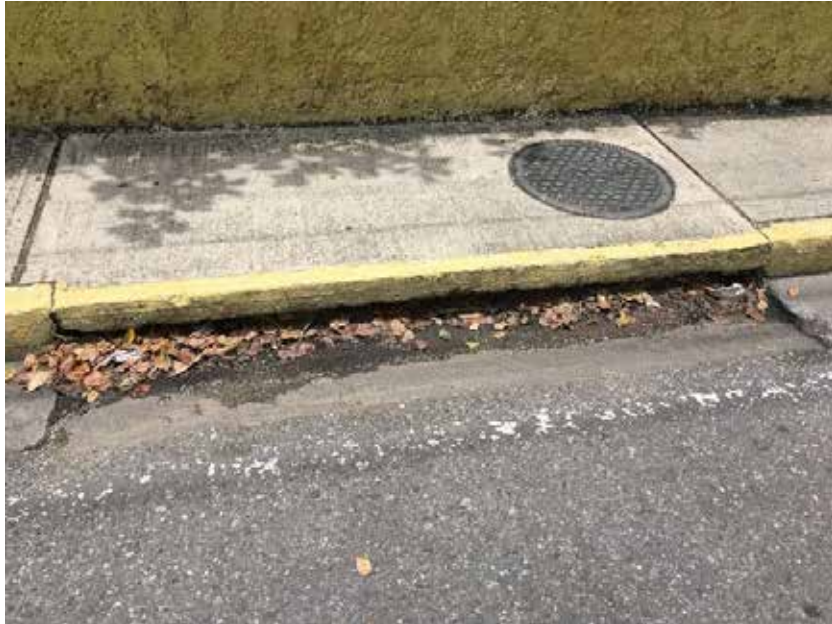
Figura 77: Sumidero de rejilla obstruido.
