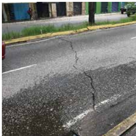
Figura 54: Fisura Transversal, abultamiento.
