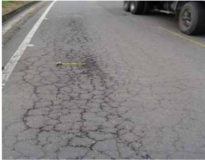
Figura 16 Ejemplo de Grietas de Piel de Cocodrilo.
