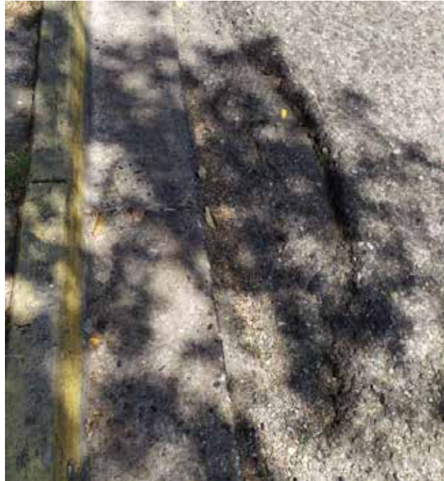
Figura 75: Falla de borde.
