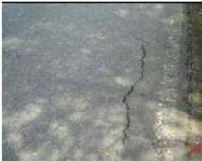
Figura 15: Ejemplo de Grietas de Contracción y/o Bloque.
