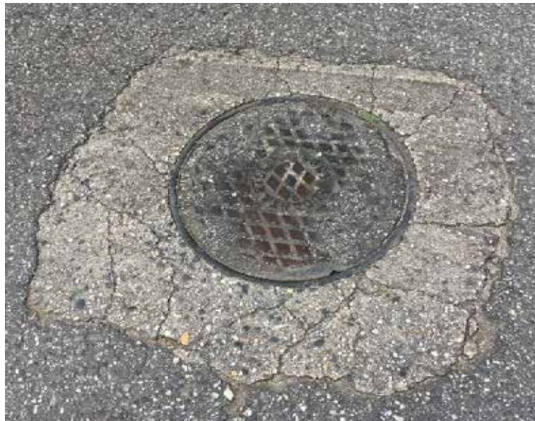
Figura 71: Boca de visita con mal bacheo y fisura longitudinal.
