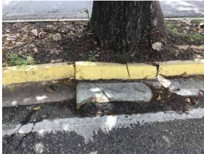
Figura 52: Falla de Abultamiento.
