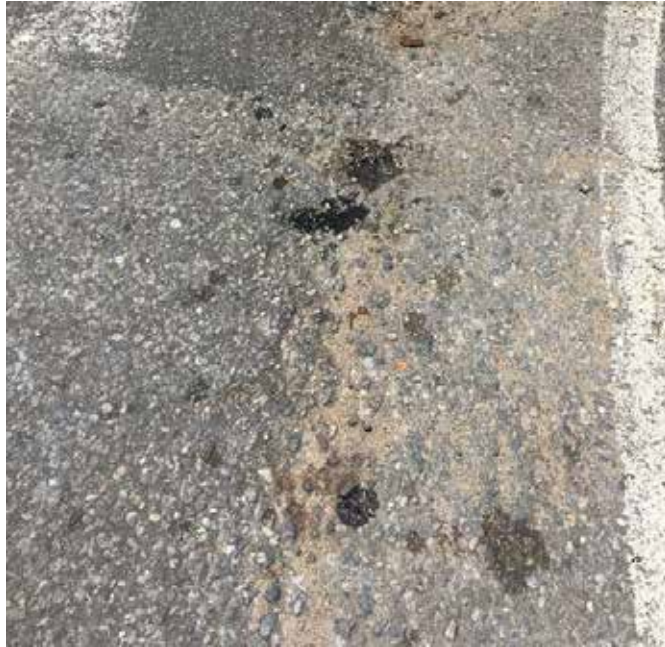
Figura 72: Perdida del agregado.
