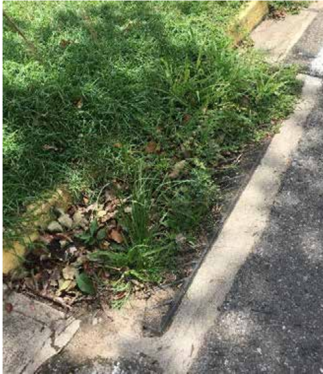
Figura 70: Sumidero de rejilla obstruido.
