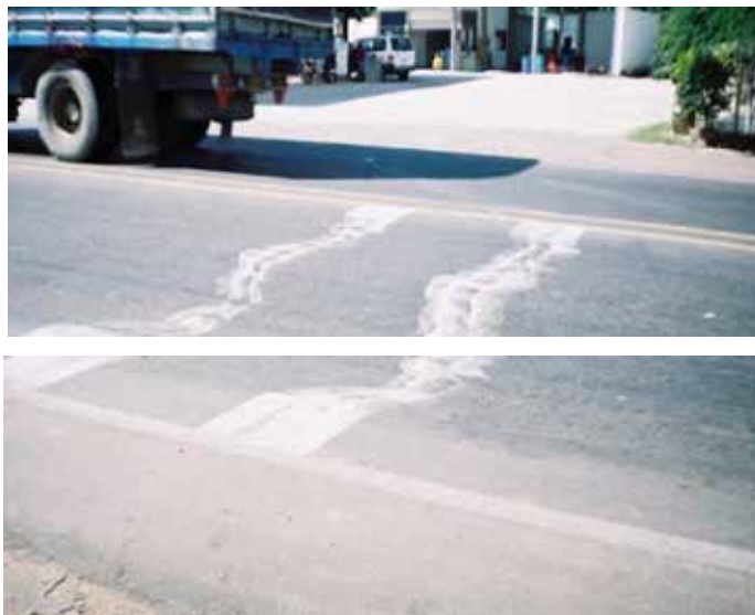
Figura 17: Ejemplo de Ahuellamiento.
