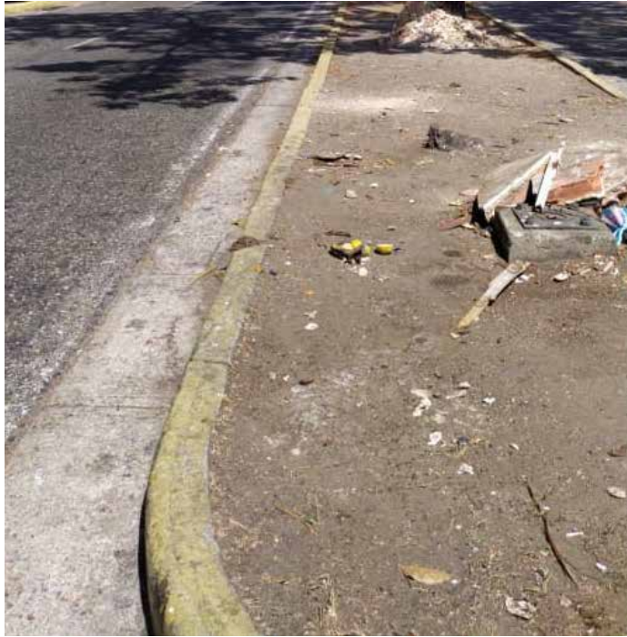
Figura 74: Poste de luz removido.
