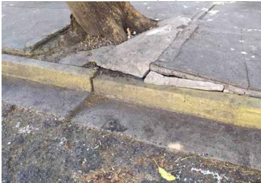
Figura 76: Levantamiento de cuneta y acera por raíz de árbol.
