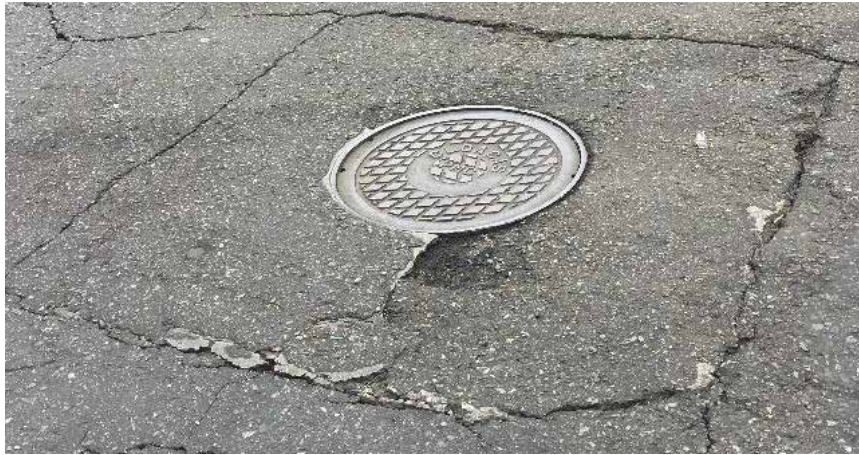
Figura 48: Falla Mal Bacheo, fisura longitudinal y elevación de tanquilla.
