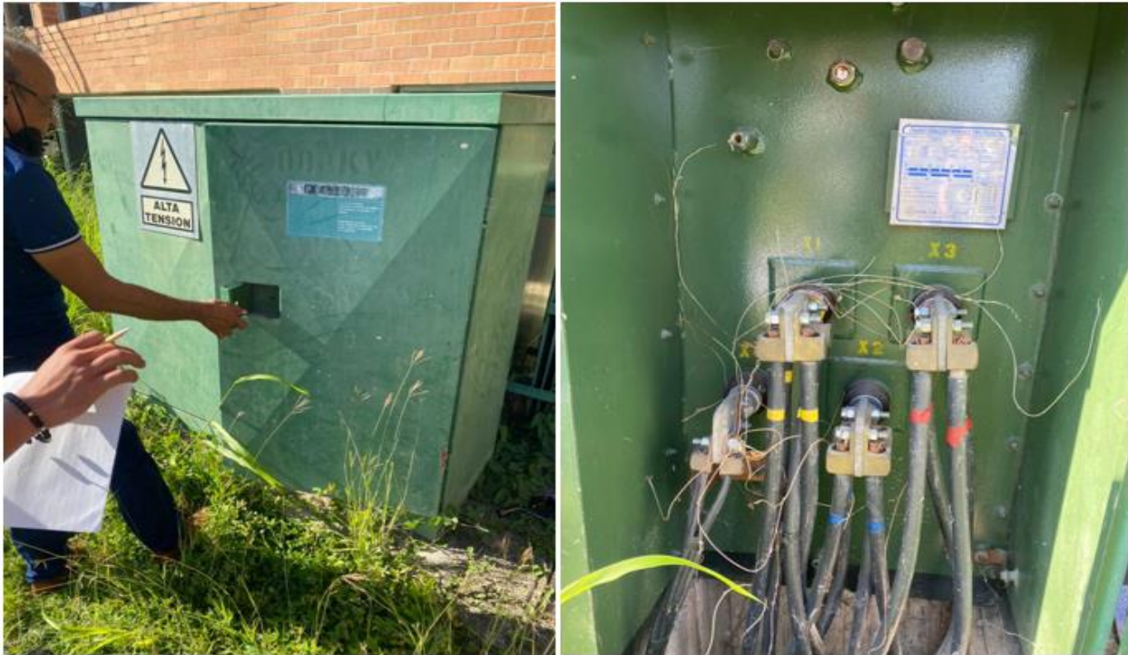
Figura 13: Medición en el transformador de 750 kVA (fachada sur del edificio 4) Fuente: Beltrán – Lavino.
