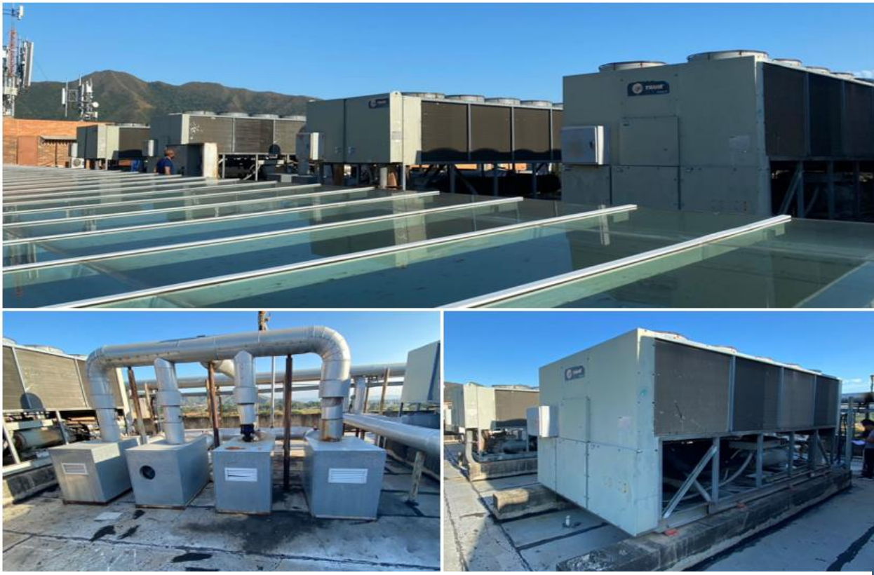
Figura 17: Sistema de agua helada (chillers)
