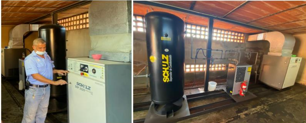
Figura 19: Unidades generadoras de aire comprimido.
