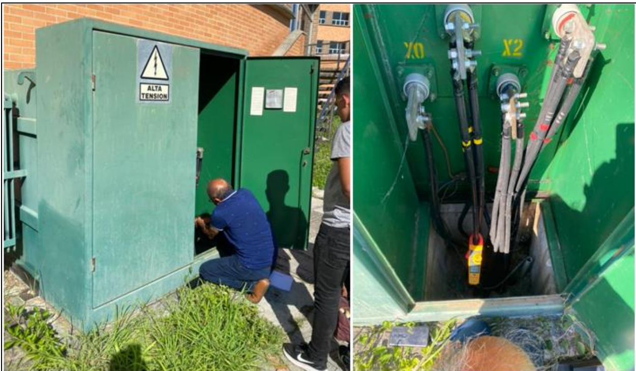
Figura 14: Medición en el transformador de 1000 kVA (fachada sur del edificio 4) Fuente: Beltrán – Lavino.
