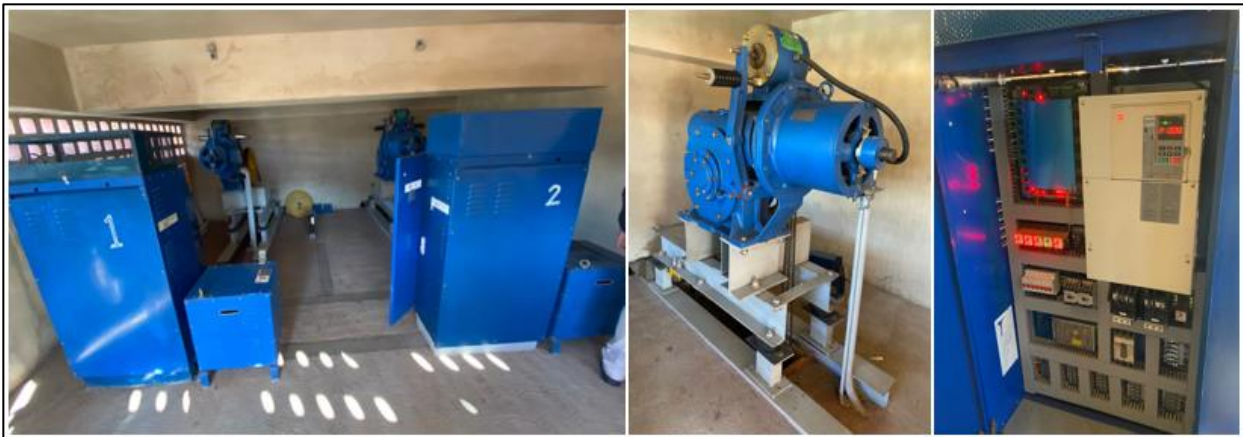
Figura 22: Sala de máquina de ascensores y tablero eléctrico
