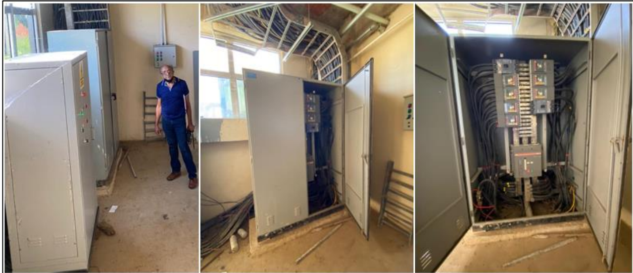
Figura 16: Tablero principal del edificio 4
